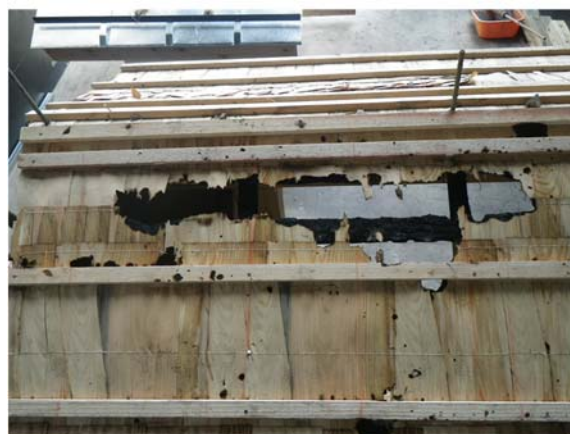
写真 5.3.5 棟部で屋根下地（卷木端）が燃え抜けた例
