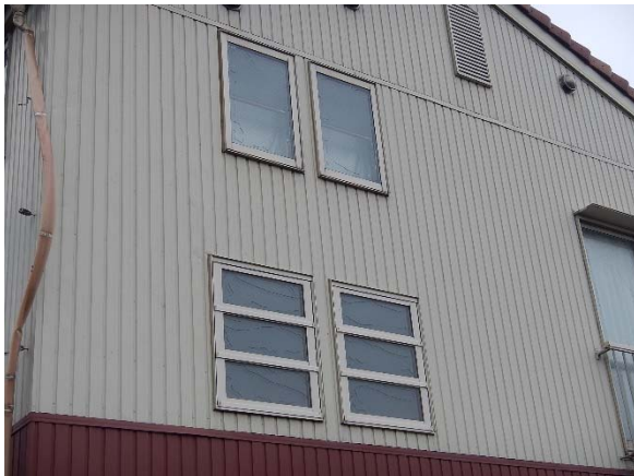
写真 3.3.12.3 網入りガラスの亀裂
