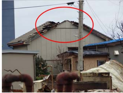
写真 5.1.1 瓦屋根への飛び火の事例
