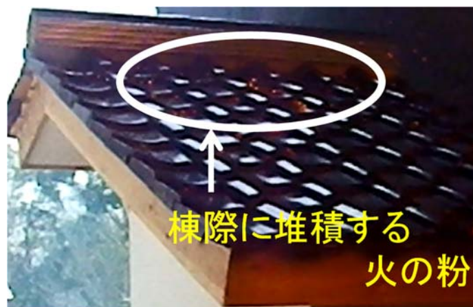
写真 5.3.3 棟際に堆積する火の粉
