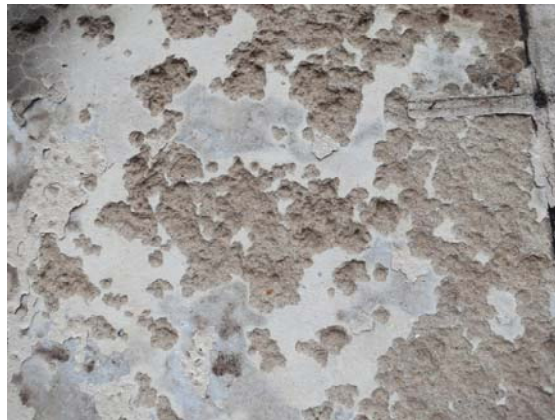
写真 3.3.17.4 爆裂した外壁の様子
