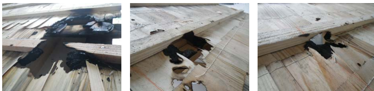
写真 5.3.6 瓦棧付近で燃え抜けた例
