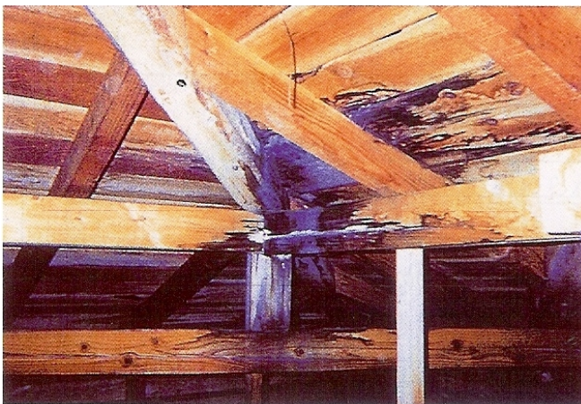
写真 6.3.8 小屋裏漏水箇所の様子
