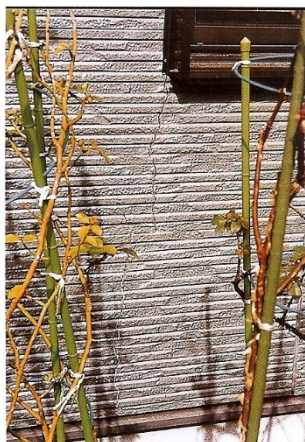
写真 6.3.5 サイディングの割れ
