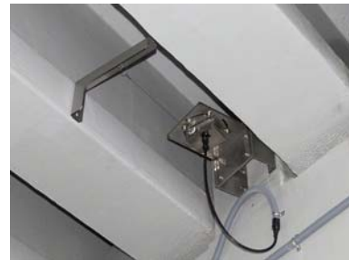
A1上流側 橋台背面盛土部計測装置
