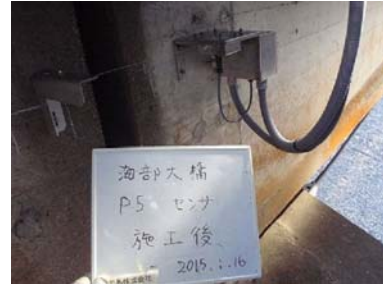
P5 桁端部支点部計測装置 (橋軸方向計測)
