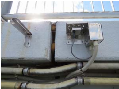
P2 桁端部支点部計測装置 (橋軸方向計測)
