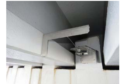
A2上流側 橋台背面盛土部計測装置
