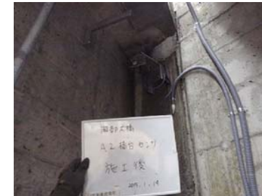
A2 桁端部支点部計測装置（橋軸方向計測）
