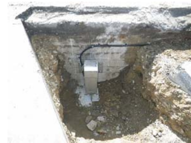
A1 橋台背面盛土部測装置（鉛直方向沈下計測）
