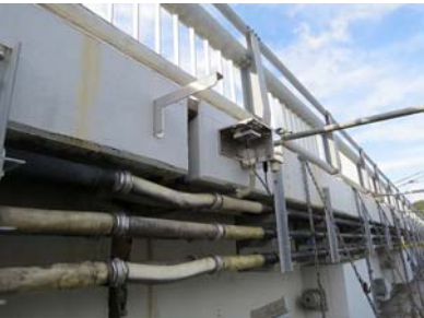
P4 桁端部支点部計測装置 (橋軸方向計測)
