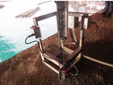
P6 桁端部支点部計測装置 (鉛直・橋軸・直角3方向計測)
