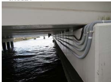
上流側 計測配線ケーブル
