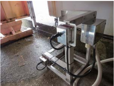
P5 桁端部支点部計測装置 (鉛直・橋軸・直角3方向計測)
