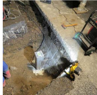
A1桁下 桁端部支点部計測装置 (橋軸方向)
