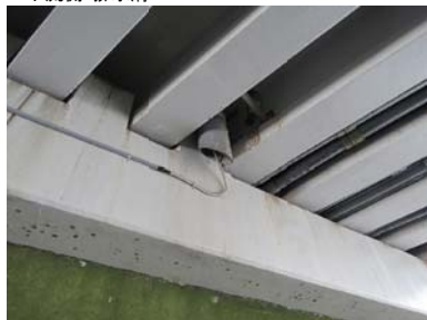
A2 計測配線ケーブル
