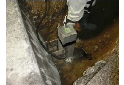
A2桁下 桁端部支点部計測装置 (橋軸方向)
