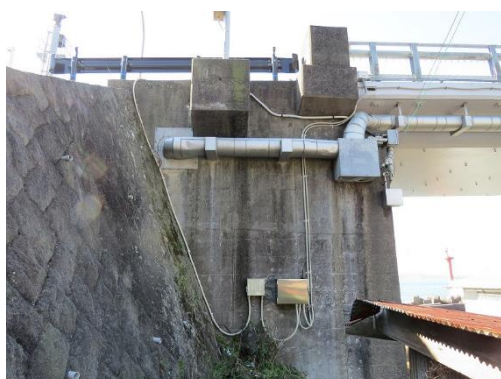
写 3-26 引き込み柱（照明）から引電事例
