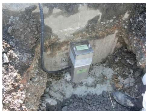
写 3-2 センサ設置状況
