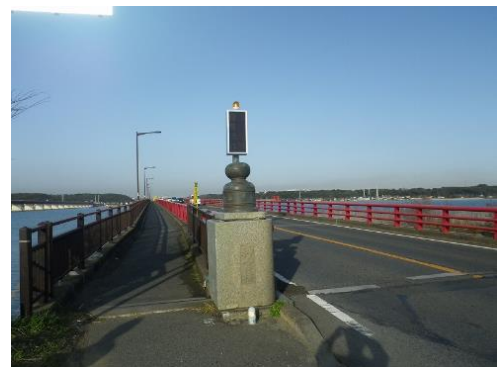
写 3-28 表示灯設置例
