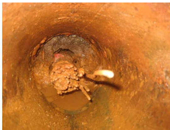
図 3.9 水の浸入により防錆材が流出、 劣化により頭部背面で破断したアンカーの事例 18)
