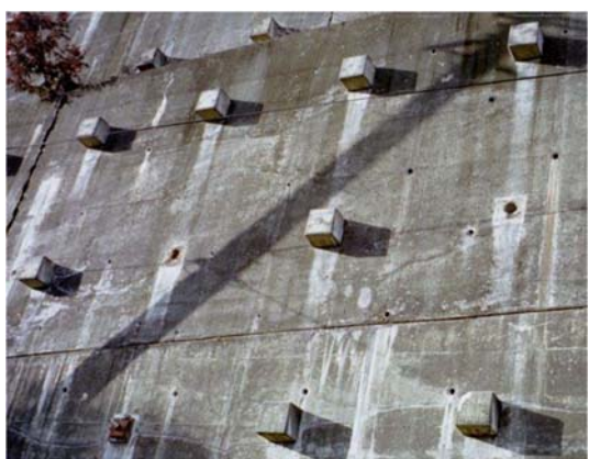
図 3.10 頭部背面で破断し、頭部コンクリート が受圧構造物から剥離、落下したアンカーの事例 18)
