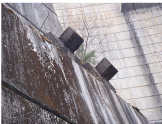
図 3.6 頭部コンクリート周辺の遊離石灰 18)
