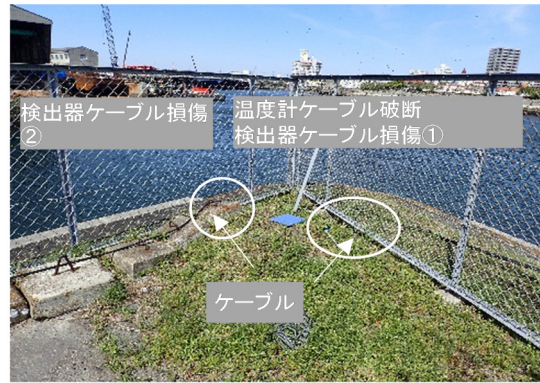
図-4.14 ケーブル破断損傷箇所
