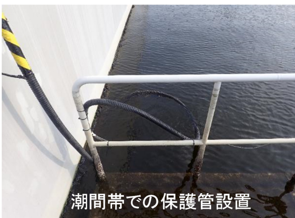
写真-B. 9 潮間帯でのケーブル保護管
