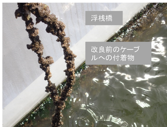
図-4.1 潮間帯部ケーブルへの付着物 (改良前)
