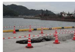
コンクリートの欠損、陥没等
