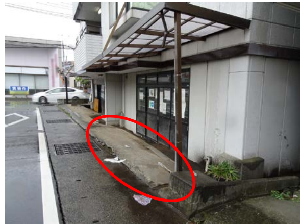
写真 5.6-61 写真 5.6-60 の建築物の 1 階部分の沈下状況
