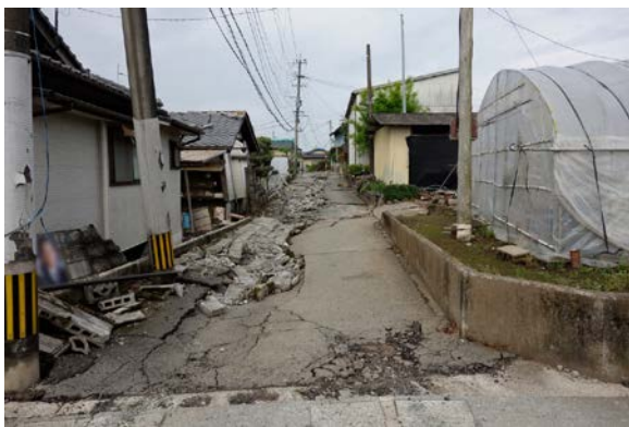
写真 5. 6-10 A 通り・県道 28 号南側の道路の舗装の様子。北側に比べて損傷が大きく見える。
