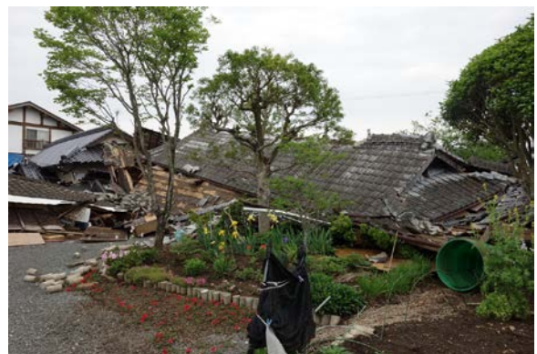
写真 5. 6-13 倒壊した建築物。県道 28 号南側は古く見える建築物が多数倒壊
