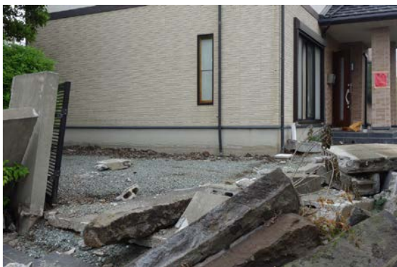
写真 5. 6-12 写真 5. 6-11 の建築物の基礎と周辺地盤。地盤変状が認められるが、基礎は無被害
