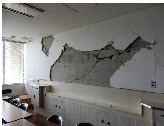
写真5.5-173 耐力壁のせん断ひび割れ
