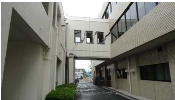
写真5.5-156 渡り廊下被害
