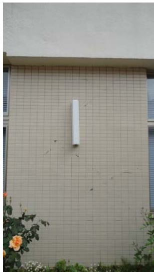
写真5.5-153 非構造壁のひび割れ
