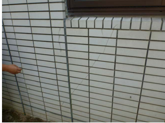
写真5. 5-130 非構造壁のひび割れ
