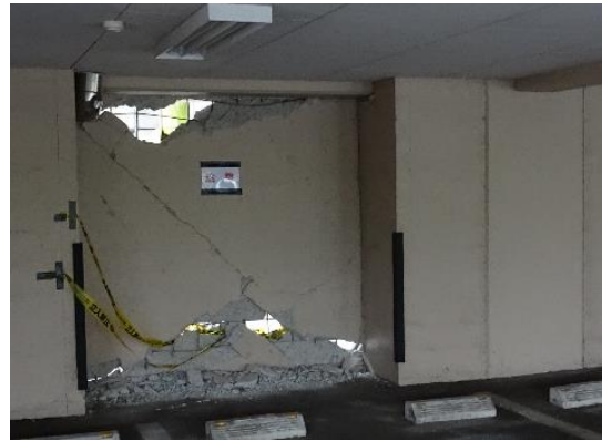
写真5.5-53 1 階桁行方向の非構造壁のせん断破壊
