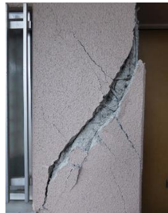
写真5.5-68 方立て壁のせん断破壊
