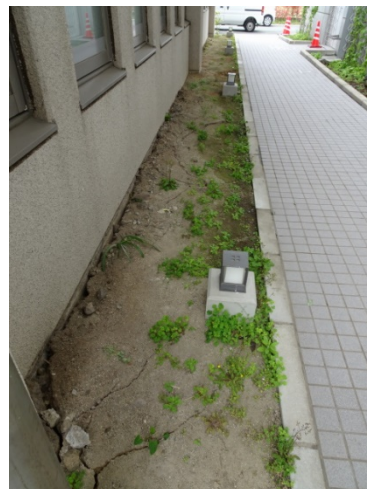
写真5.5-125 建築物に接する地盤のひび割れ
