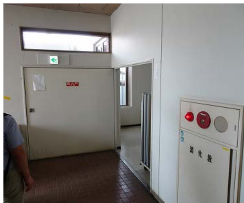
写真5.5-171 応急措置された防火戸
