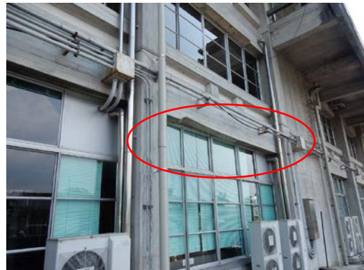
写真5.5-274 大梁下端のコンクリートの剥落
