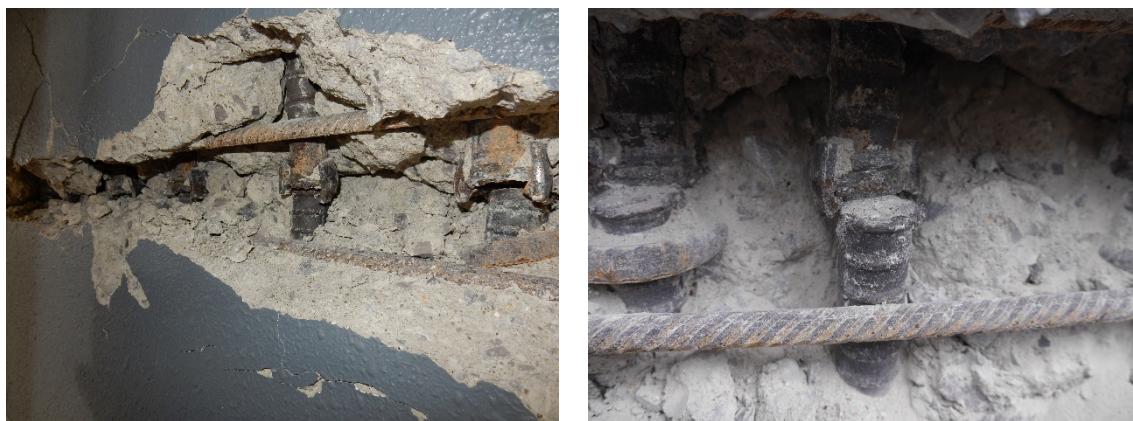
写真5.5-11 主筋破断部の拡大
