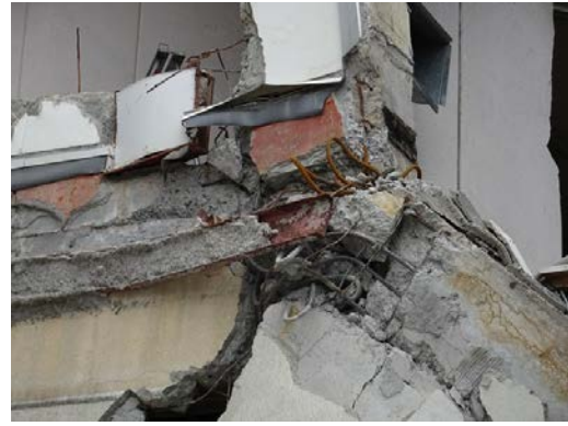
写真5.5-221 柱頭部の破壊（南面）
