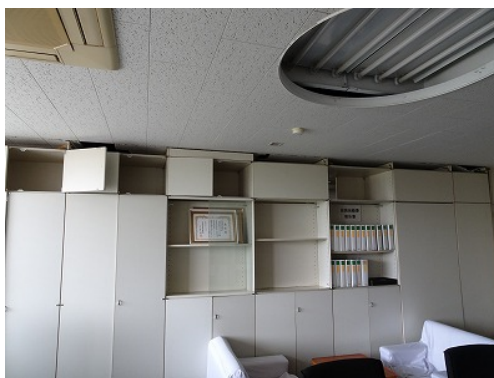
写真5.5-169 什器天端の天井材の被害
