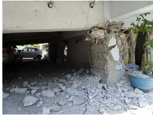
写真5.5-212 破壊した北側の1階柱
