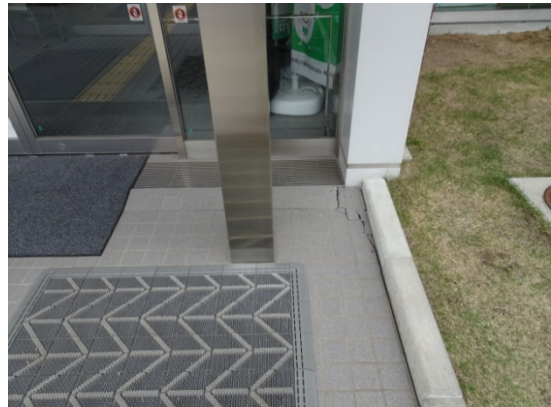
写真5.5-123 エントランス部分の床ひび割れ
