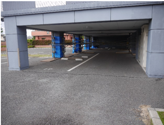
写真5.5-9 1階（ピロティ層）の被害
