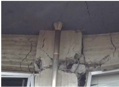
写真5.5-196 5階柱頭部の破壊
