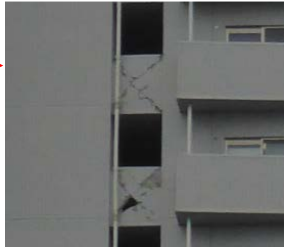
写真5. 5-104 廊下手摺壁のせん断破壊
