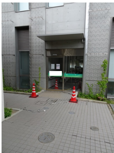
写真5.5-124 南側外構のひび割れ
