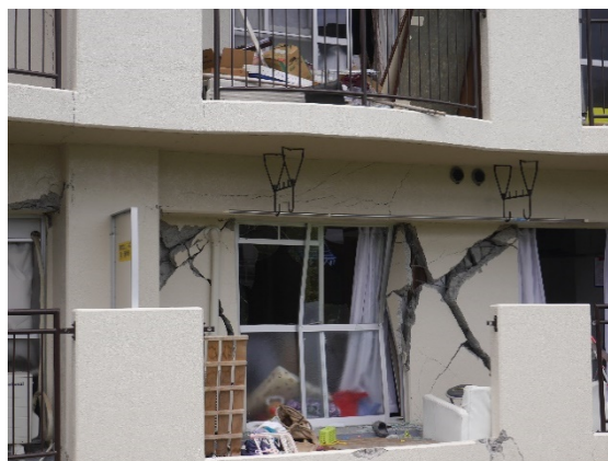
(b) 2階梁のひび割れ
