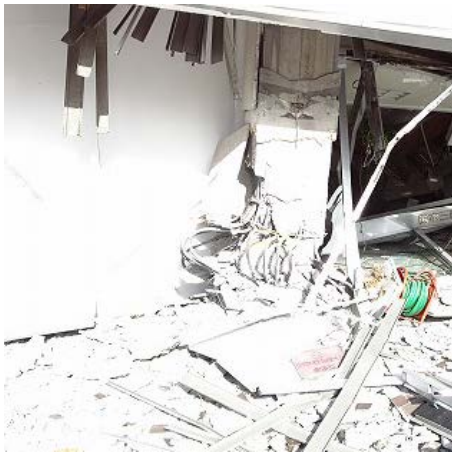
写真5.5-215 柱の軸崩壊、鉄筋座屈
