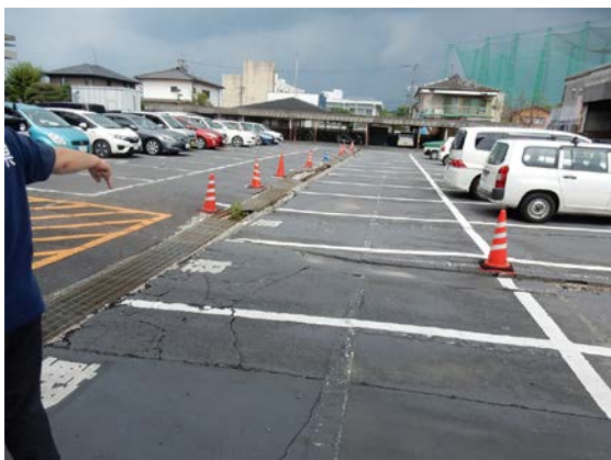
写真5.5-178 建築物周辺の地盤変状
