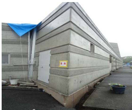
写真5.5-139 建築物北東面の地盤沈下
