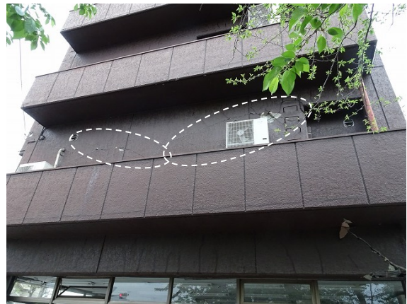
写真5.5-255 耐力壁のせん断ひび割れ（東側）
