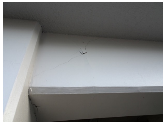
写真5. 5-245 桁行方向の梁端のせん断ひび割れ
