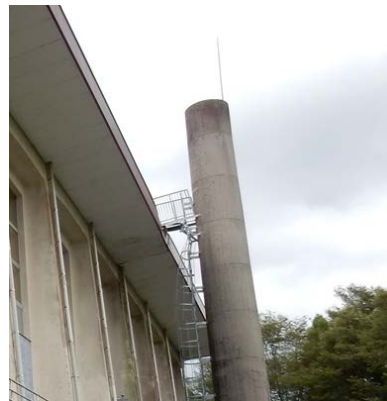
写真5. 5-191 隣接する煙突の梯子の変形
