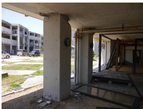
(a) 東側から見た柱全景
