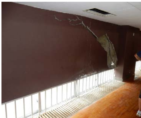
写真5. 5-190 非構造壁のせん断破壊
