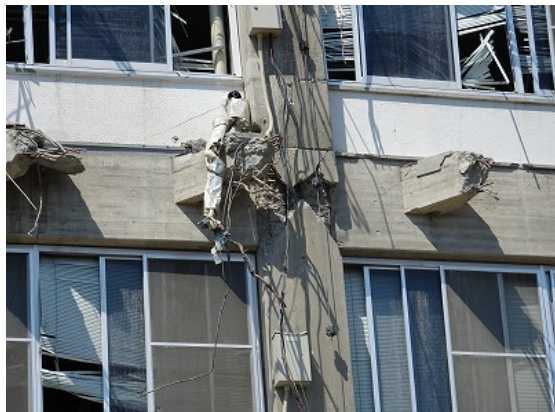
写真5.5-202 4階十字形柱梁接合部の損傷（南東側）
