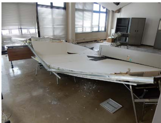
写真5.5-181 間仕切り壁の転倒
