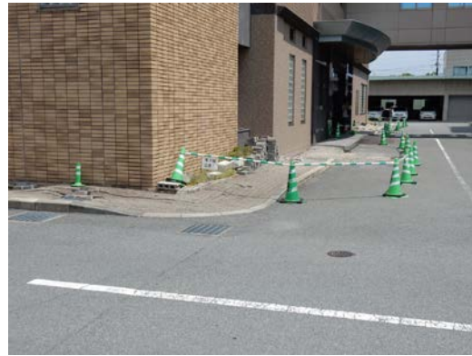
写真5.5-142 建築物周辺の地盤変状
