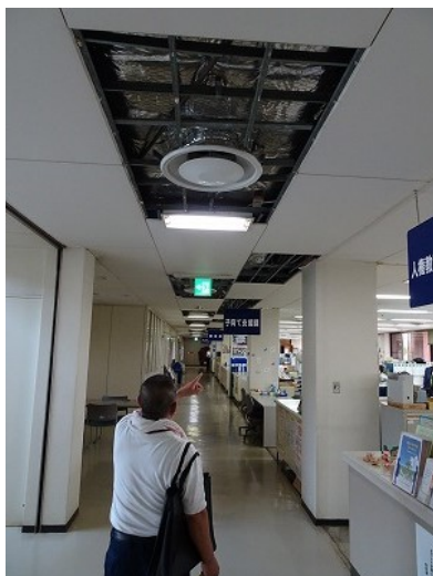
写真5.5-170 2階天井の脱落
