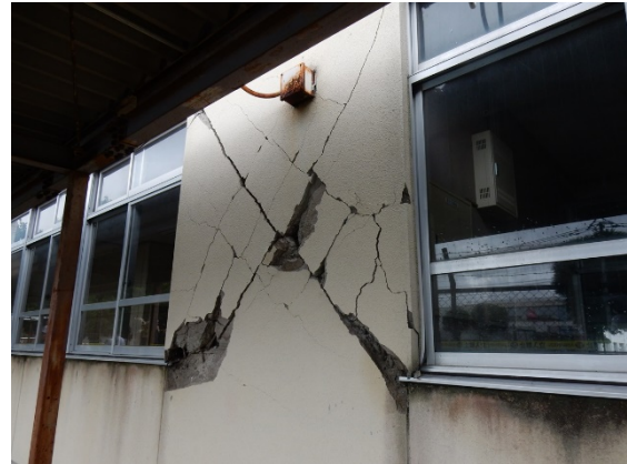
写真5. 5-297 方立壁の被害
