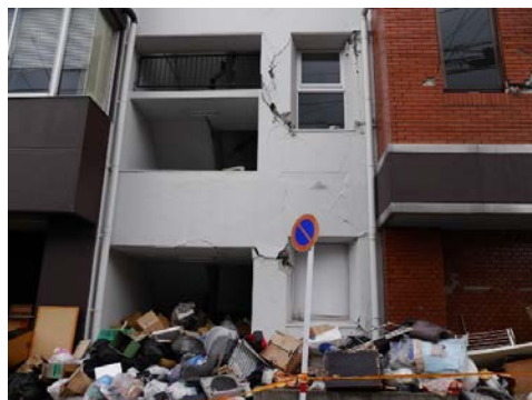
写真5. 5-249 2階階段室の柱の損傷
