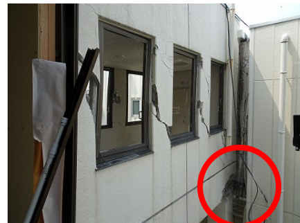
写真5.5-157 渡り廊下被害柱梁接合部被害
