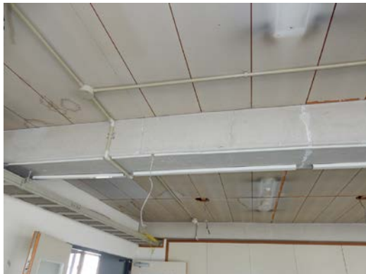
写真5.5-273 大梁のスパン中央付近のひび割れ
