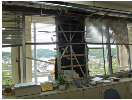
写真5.5-175 窓ガラスの破損
