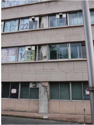
写真5. 5-305 建築物北西面における各階柱の損傷
