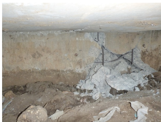
写真5.5-29 1階バルコニー下の基礎部分の損傷
