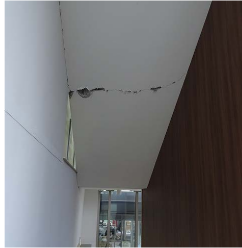
写真5. 5-127 階段底面に見られたひび割れ
