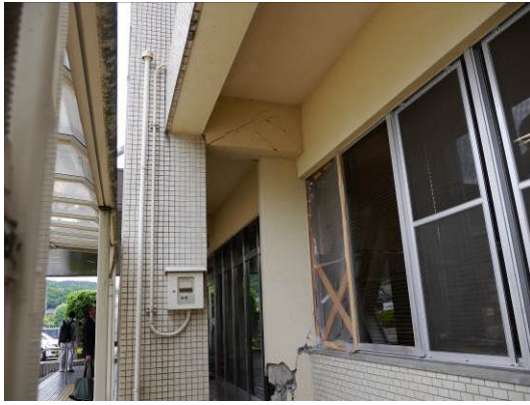
写真5.5-174 短スパン梁のせん断ひび割れ
