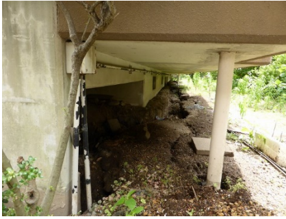
写真5.5-92 建築部外周部の地盤の亀裂
