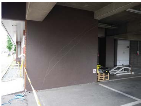
写真5. 5-248 1階耐力壁のせん断ひび割れ
