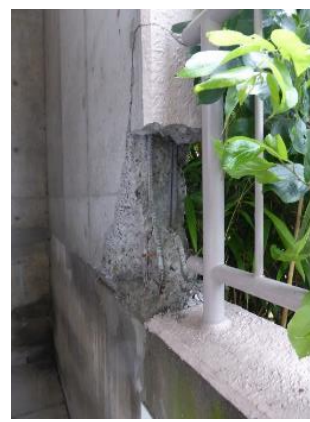
写真5.5-72 駐車場の桁行方向非構造壁の損傷
