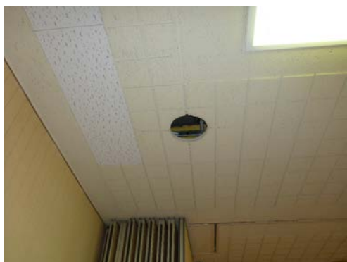
写真5.5-135 天井材の脱落
