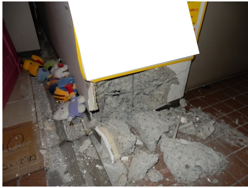
写真5.5-265 2階耐力壁の曲げ圧縮破壊
