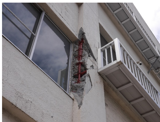
写真5. 5-302 2階柱のコンクリートの剥落
