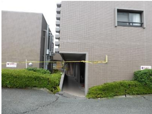
写真5. 5-86 建築物と外周地盤の段差
