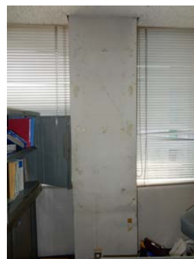
写真5.5-268 柱のせん断ひび割れ
