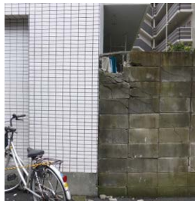
写真5.5-76 柱の傾斜方向（写真矢印）にあるコンクリートブロックの破壊とせん断ひび割れ
