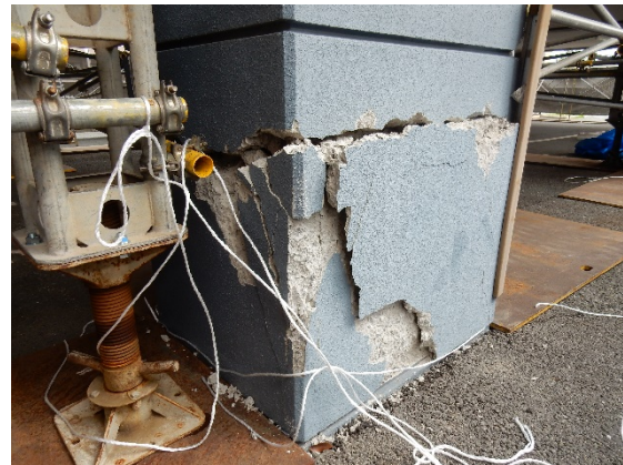
写真5.5-10 1階柱の水平ひび割れ
