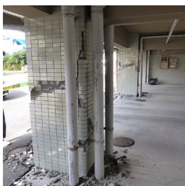
写真5. 5-37 1階柱桁行方向のせん断破壊
