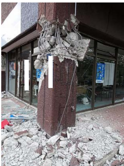
写真5.5-256 1 階柱の大破（南東側）
