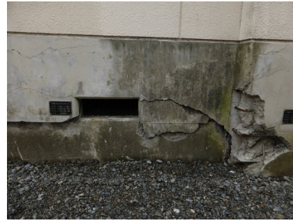
写真5.5-93 基礎立上り部の損傷
