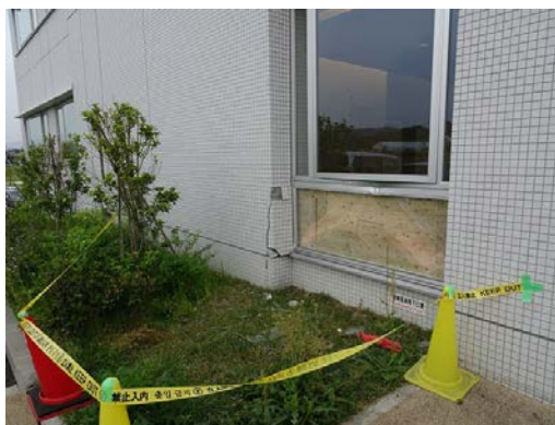
写真5.5-110 耐力壁脚部の損傷
