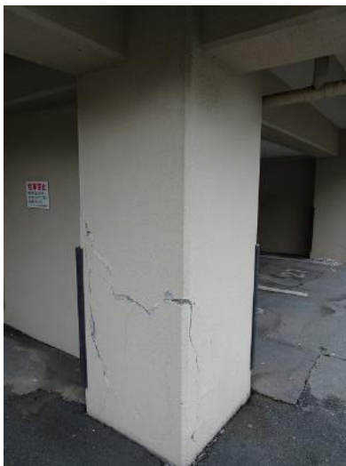
写真5.5-54 1 階柱のひび割れ
