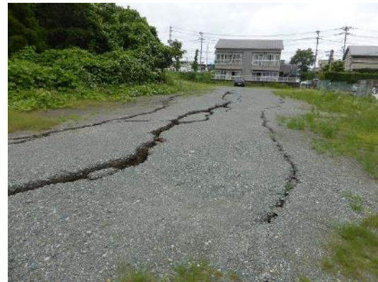
写真5. 5-87 周辺地盤の地割れ
