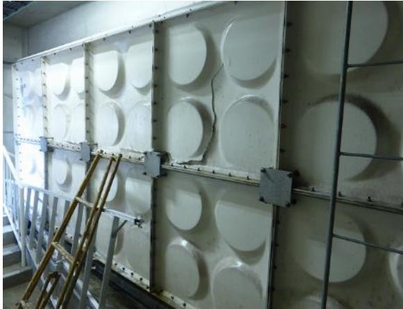
写真5.5-69 FRP 受水槽の破損
