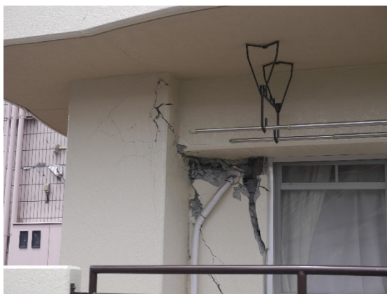
(a) 柱端部の圧壊
