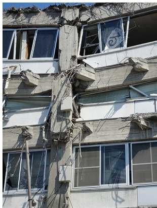
写真5.5-201 4、5階十字形柱梁接合部の損傷（南西側）
