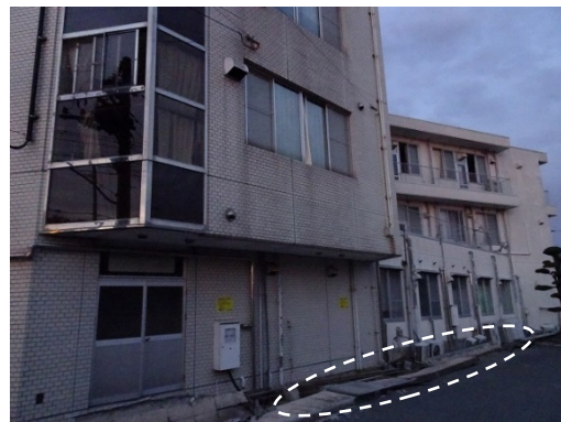
写真5.5-261 コンクリートブロック塀の倒壊
