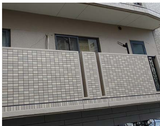
写真5.5-44 方立て壁のせん断ひび割れ
