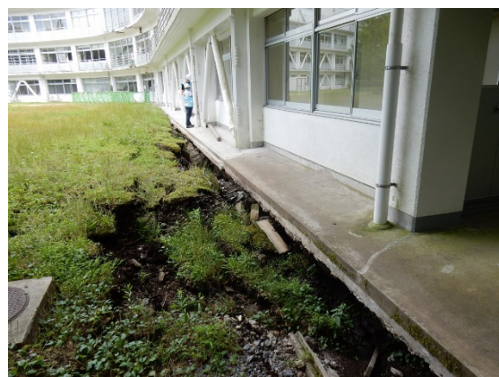
写真5.5-184 建築物北西側における地盤変状
