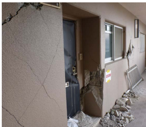
写真5.5-19 2階共用廊下側の方立壁の被害
