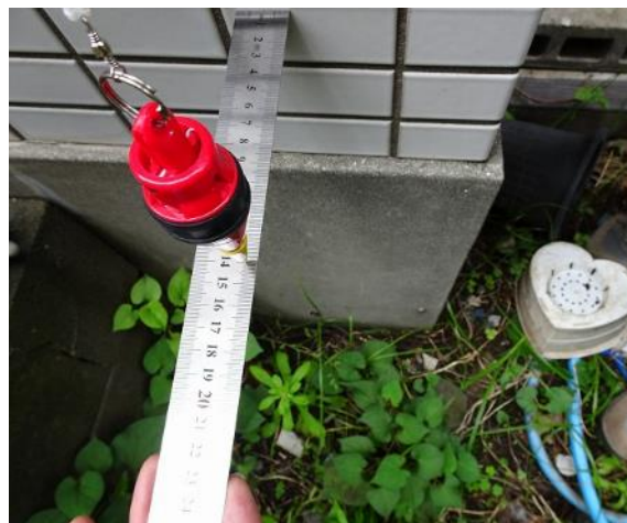
写真5.5-78 下げ振りによる柱の傾斜測定
