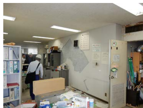
写真5.5-270 仕上げモルタルの剥落
