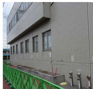
写真5. 5-106 外壁タイルの剥落 （管理棟南側）
