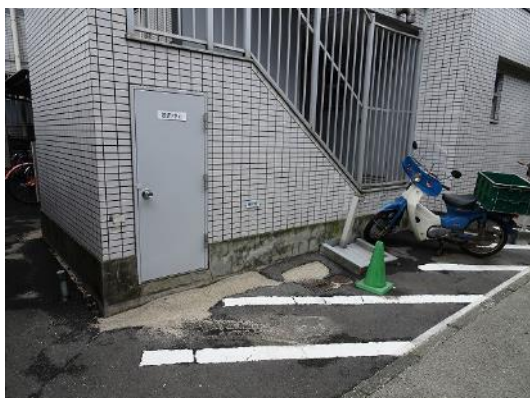
写真5.5-75 表層アスファルト路盤の凹凸
