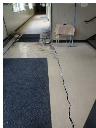
写真5.5-284 1階スラブのひび割れと段差
