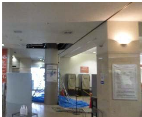
写真5.5-108 天井仕上材の脱落（南側病棟）
