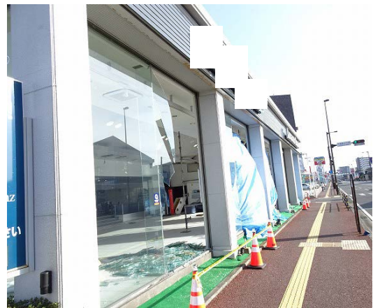
写真5.5-216 隣接店舗はガラス破損のみ
