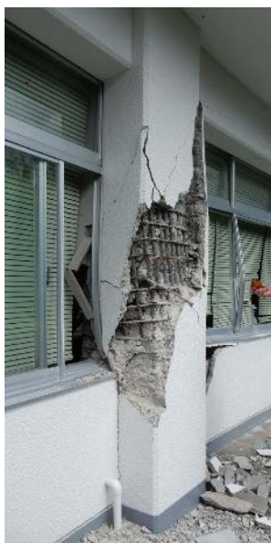
写真5.5-186 柱のせん断破壊
