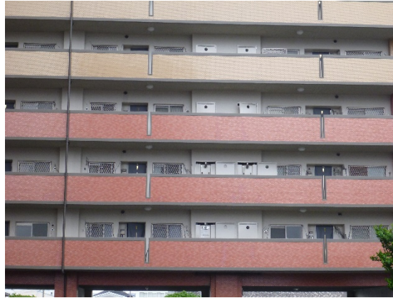
写真5.5-96 非構造壁の損傷
