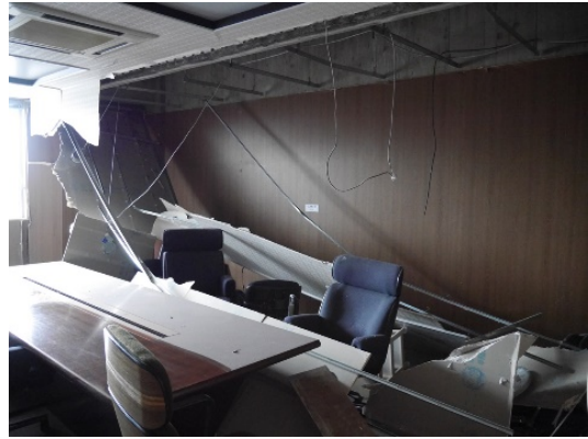
写真5.5-266 天井材の落下被害
