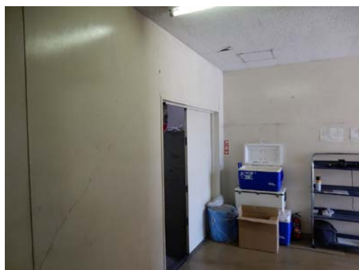
写真5. 5-280 耐力壁のせん断ひび割れ
