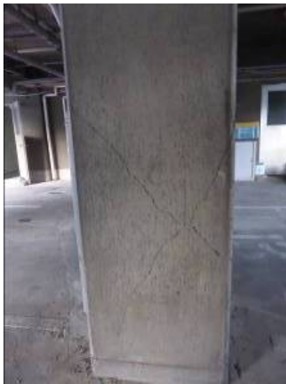
写真5.5-240 1階柱のせん断ひび割れ
