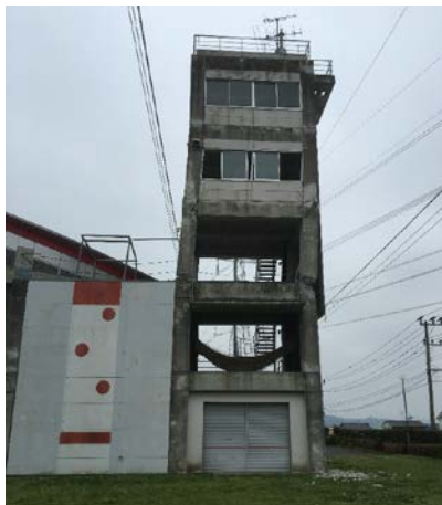
写真5.5-24 本震後の主訓練塔の被災状況
