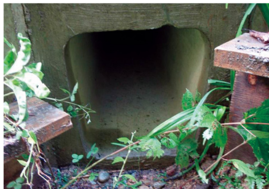
写真1-9 クロサンショウウオ用 ボックスカルバート〈八箇峠道路〉
