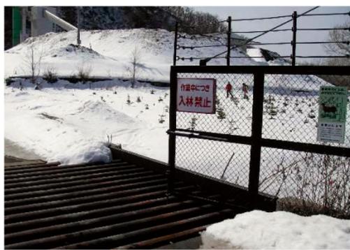
写真1-22 併設した開閉ゲート
