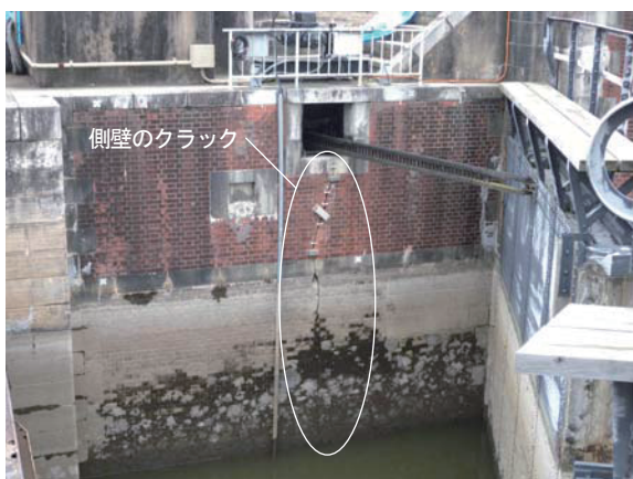
図-13 底部まで達する横利根閘門閘頭部側壁のクラック （撮影：阿部，2013.11.15）
