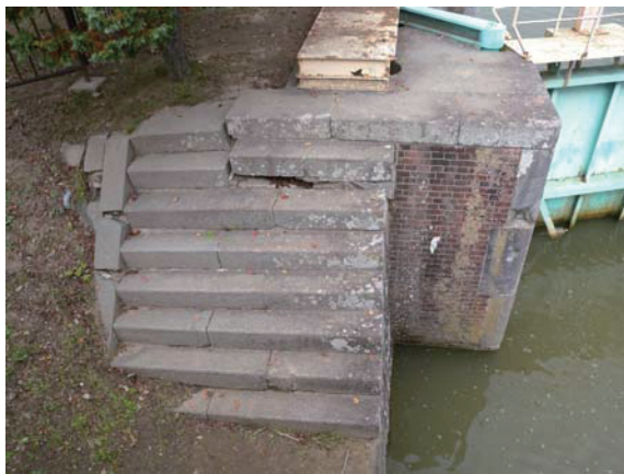
図-2 石井閘門の閘頭部の階段（右岸側） 階段部のズレが被災時のまま存置されている （撮影：阿部，2013.10.31）
