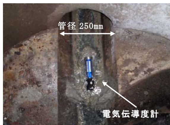
図 1-3 電気伝導度計の設置状況
