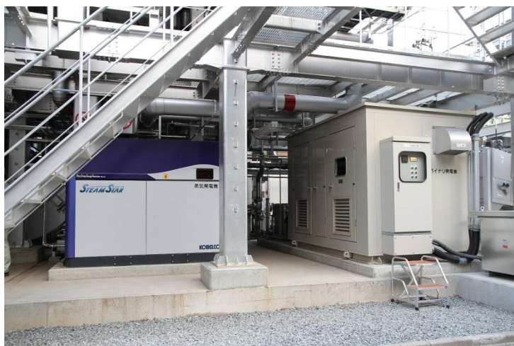
図 2-16 実証設備におけるエネルギー変換設備の外観 (左：スクリュ式小型蒸気発電機、右：蒸気バイナリー発電機)
