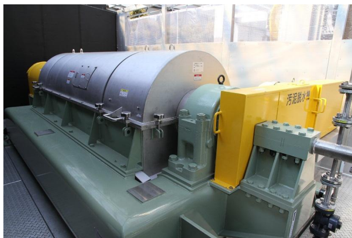
図 2-8 実証設備における機内二液調質型遠心脱水機の外観
