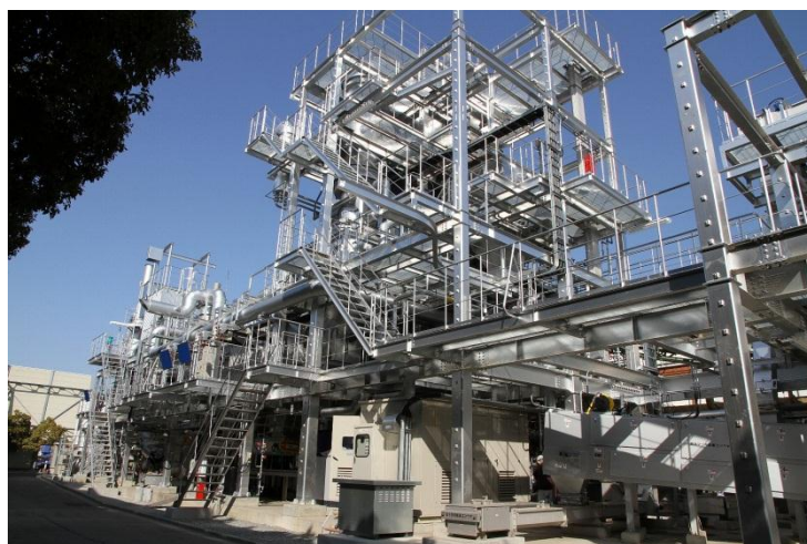
図 2-10 実証設備におけるエネルギー回収設備の外観
