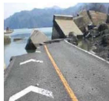
津波で被災した国道 45 号
