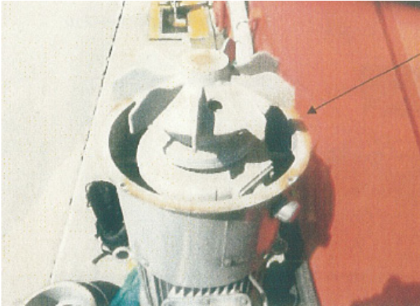
図-A. 12. 368 走行モータの損傷状況（4号機）
