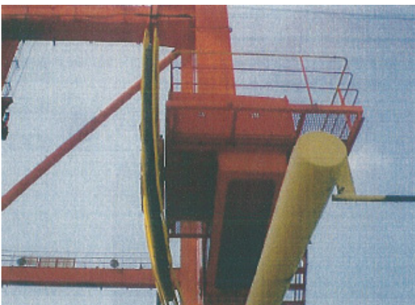
図－A. 12. 359 ケーブルリールの損傷（２号機）
