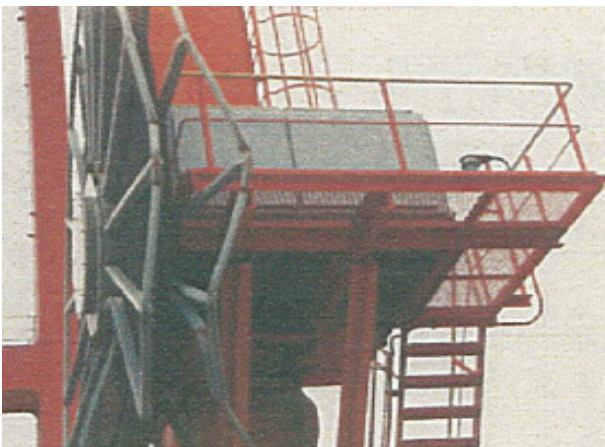
図-A. 12. 354 ケーブルリールガイドローラブラケット の折損 (1号機)
