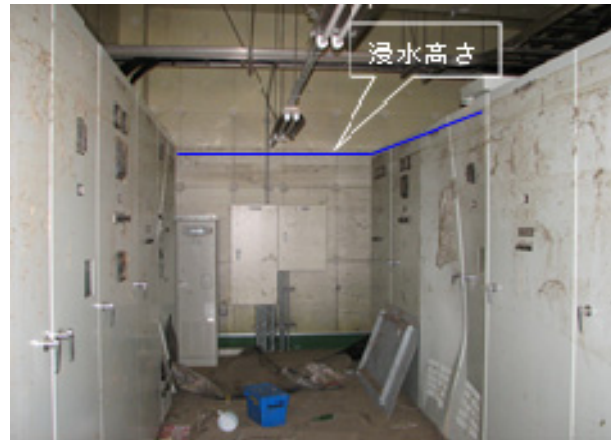
図-A. 12. 371 受変電室の様子
