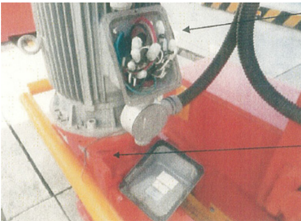
図-A. 12. 369 走行減速機の損傷状況（4号機）
