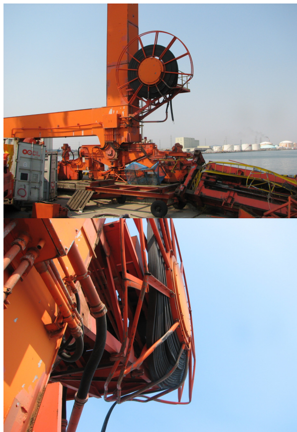
図ーA. 12. 363 給電ケーブル及びケーブルリールの損傷 状況（3号機）
