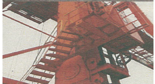
図一A. 12. 352 陸脚取付階段の損傷（1号機）
