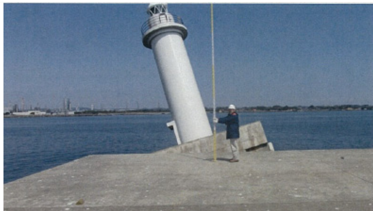
①堤頭函の傾斜（天端より）
