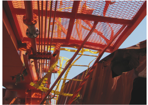
図-A. 12. 366 油圧配管群の損傷（3号機）
