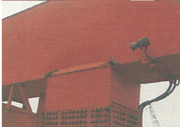
図一A. 12. 350 係留装置支持ブラケットとシルビームに発生した座屈（陸脚，1号機）
