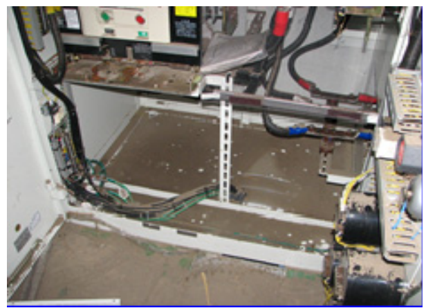
図-A. 12. 372 盤内に砂が堆積している様子
