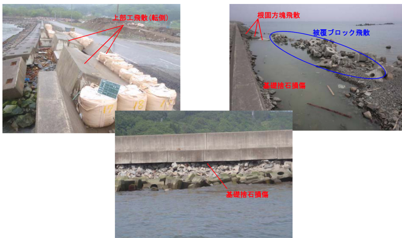
図－A. 4. 13 No. 1 半崎地区_1 号護岸の被災状況
