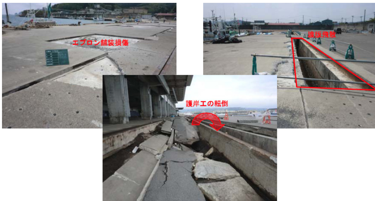
図－A. 4. 108 No. 3 掘込地区_4. 5m-6. 0m 岸壁の被災状況
