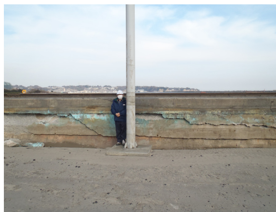
写真-4.8.1(a) 液状化事例 (陸側レール直角方向)
