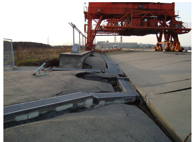
写真-4.6.4 小名浜港 5号埠頭岸壁 (-12m) 被災状況
