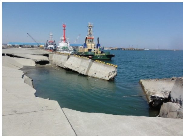
(a) 鋼矢板壁の倒壊
