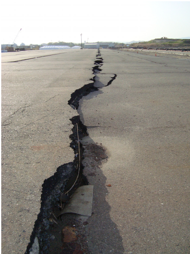
写真-4. 6. 5 小名浜港藤原埠頭岸壁（-12m）被災状況
