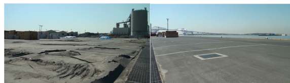
写真-4.8.6 地震後の状況（左側が未改良区域）
