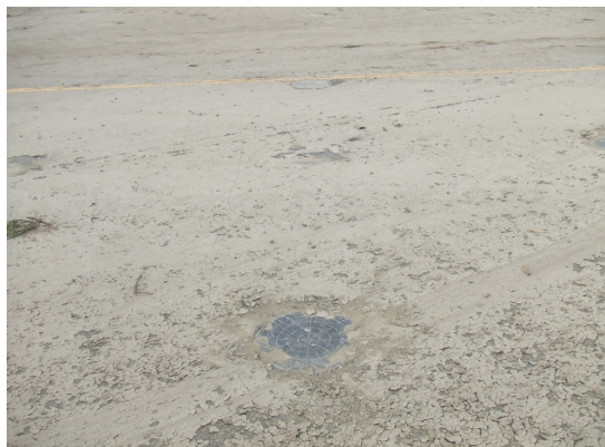
写真-4.8.3 地震後の状況（高圧噴射）
