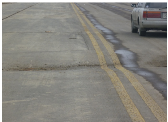
写真-4.8.4 地震後の状況（未施工部）
