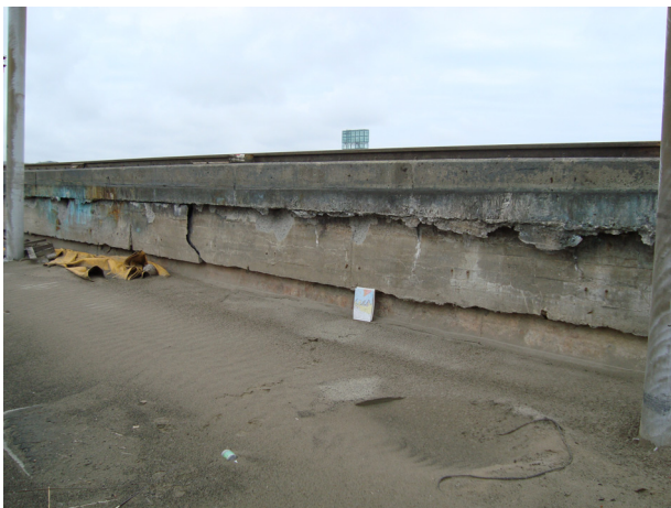
写真-4.6.3 小名浜港 3号埠頭 3-2 岸壁の背後における段差(段差の下端に置かれている紙は A4 サイズ)
