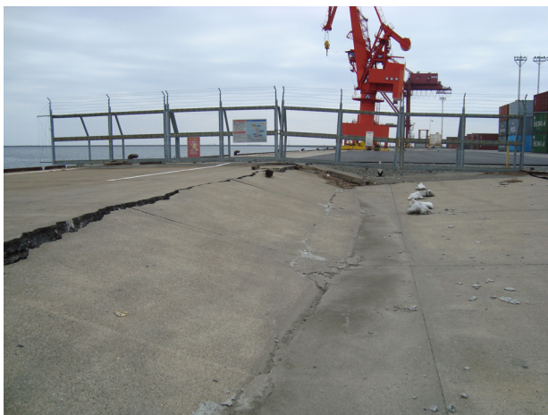
写真-4. 6. 6 小名浜港大剣埠頭岸壁（-7.5m）被災状況
