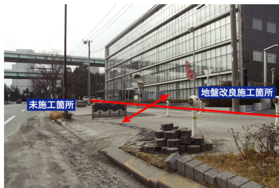
写真-4.8.2 地震後の状況（締固め工法）
