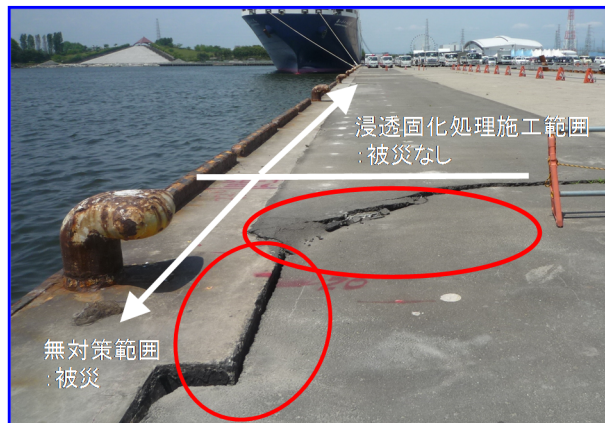
写真-4.8.5 地震後の状況（浸透固化）
