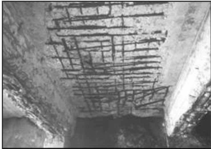
図－１．２ 栈橋上部工下面の状況 鉄筋の腐食によるコンクリートの剥離（提供：港空研）
