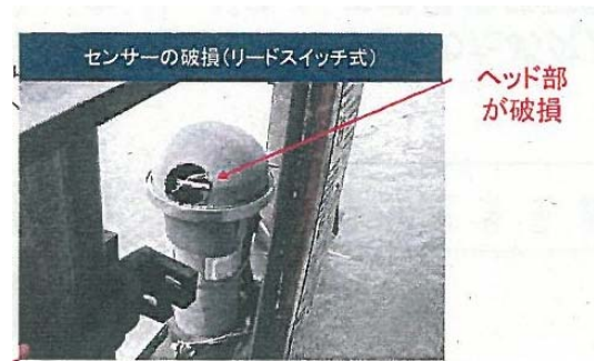
写真-6.2.1 水位計の破損 （山国川柿坂水位観測所）
