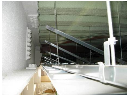
写真 2.4 斜め部材の溶接部の破断
