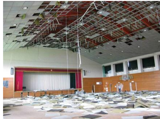
写真 1.2 体育館（システム天井）の被害
