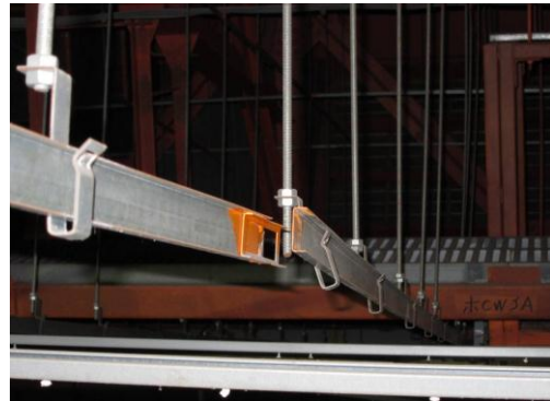
写真 2.2 野縁受けジョイントの外れ
