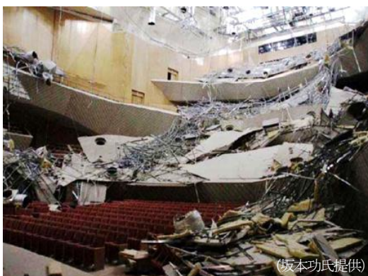
写真 1.3 大規模ホールの被害
