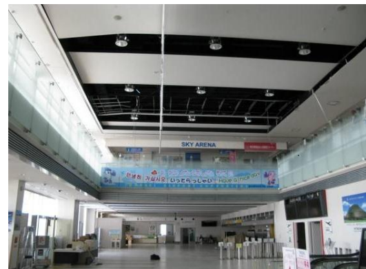
写真 1.4 空港ロビーの被害
