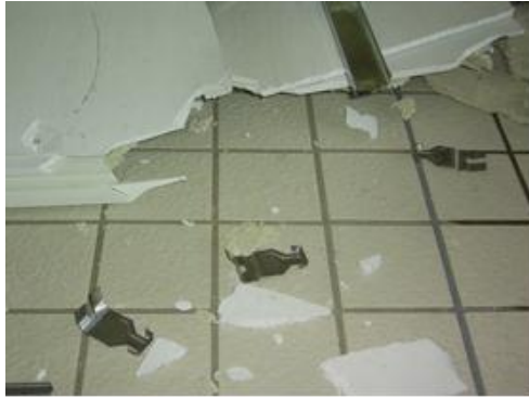
写真 2.1 クリップの損傷・外れ
