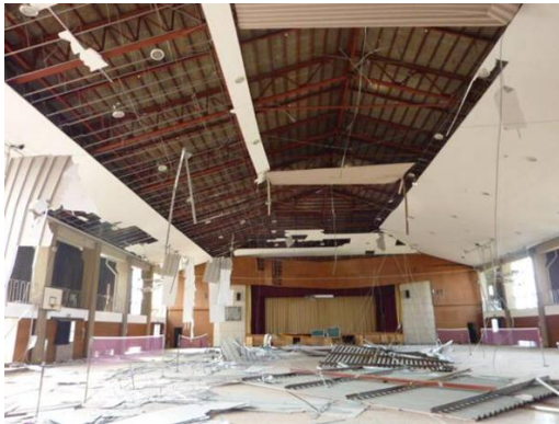
写真 1.1 体育館（在来工法の天井）の被害
