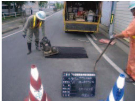
陥没地点画像
