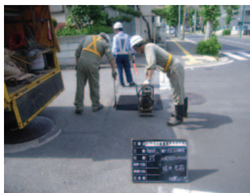
陥没地点画像
