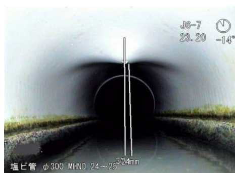
写-3 変形の事例
