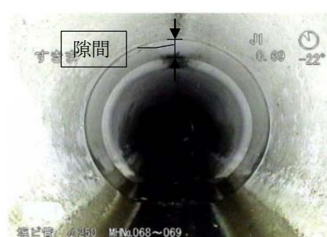
写-4 隙間の事例
