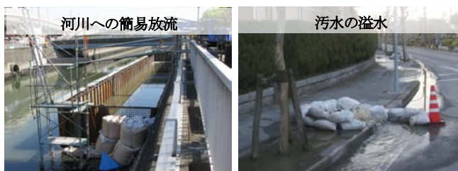
図-8 溢水及び簡易放流状況
