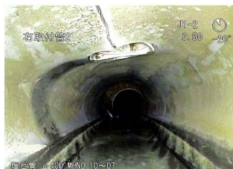
写-1 破損の事例
