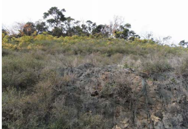
写真-6.12 工法変更が必要なのり面
