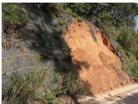
写真-6.1 強雨によるのり面崩壊
