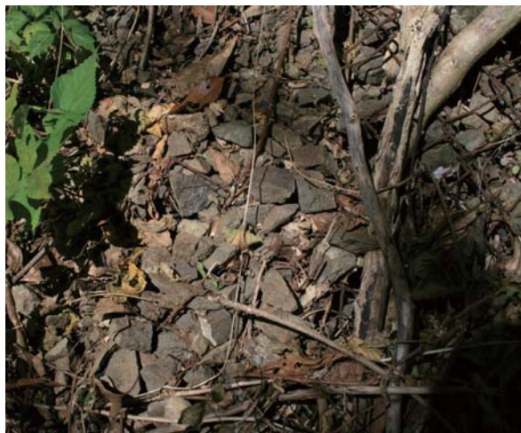
写真 -6.15 のり面地山の風化例
