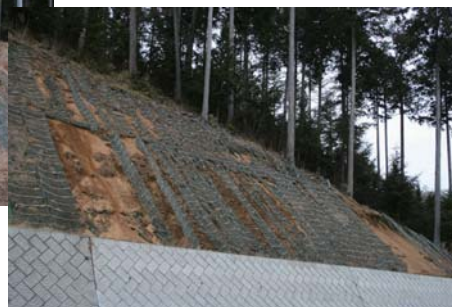
【のり面の表層崩落段階】
