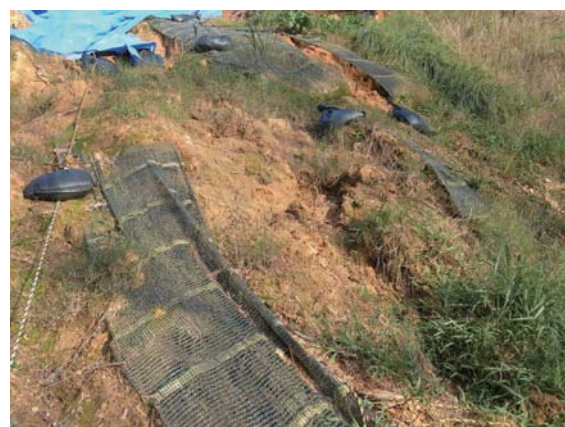
写真-6.4 台風による植生マットの剥離
