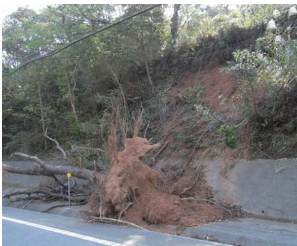
写真 -6.16 倒木によるのり面の崩壊
