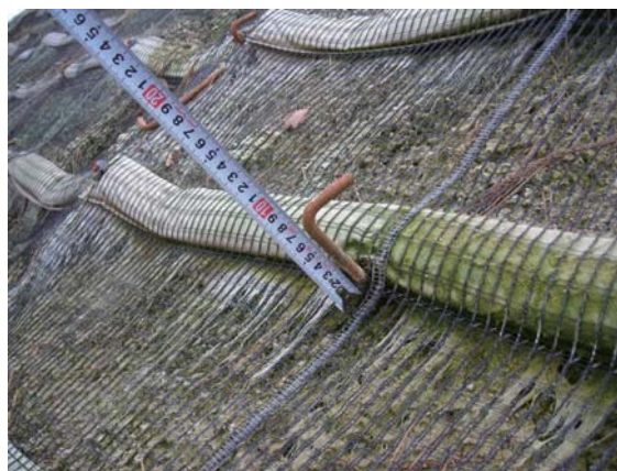
写真-6.9 土壌凍上によるアンカーピンの浮上り
