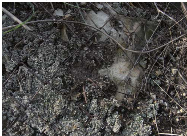
写真-6.7 金網の腐食・破損
