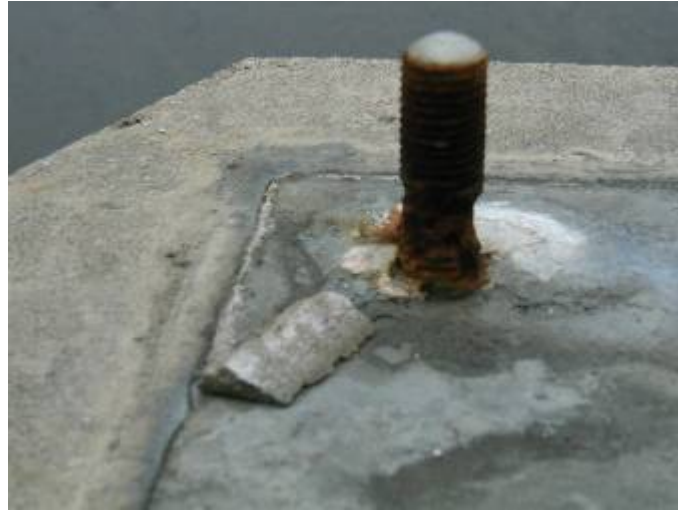
写真一解 6. 2 転用部材のアンカーボルトの損傷事例
