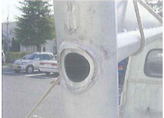
(b) アルミ製デザイン照明柱横梁アーム落下 (強風時に損傷)
