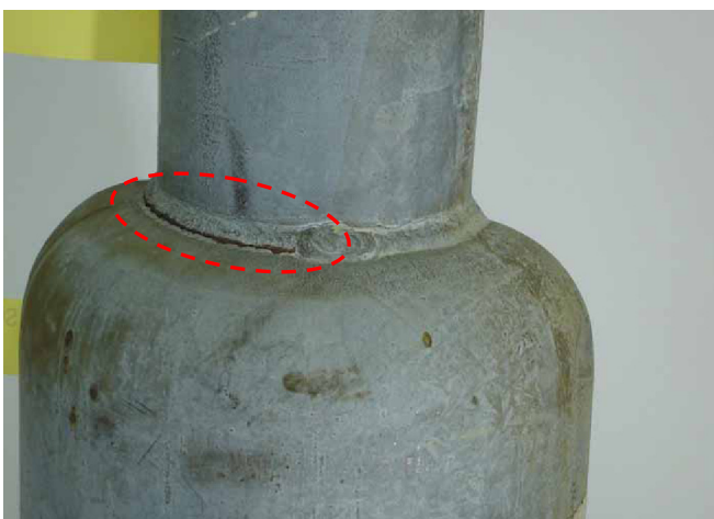
(a) 照明柱断面変化部の溶接に確認されたき裂 (歩道橋, 15 年経過)
