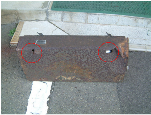
(a) 落下照明背面状況
