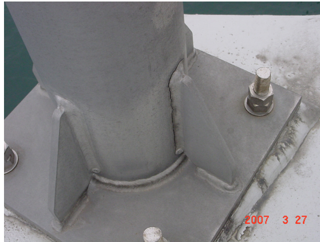
標識柱基部溶接部のき裂 写真一解 7. 4 支柱基部のき裂事例
