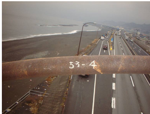
写真一解 7. 10 支柱本体の腐食事例
