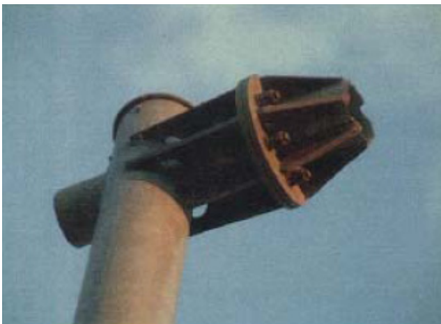
(a) 標識横梁基部の破断による標識板落下 (強風の多い海岸付近, 2 年経過)
