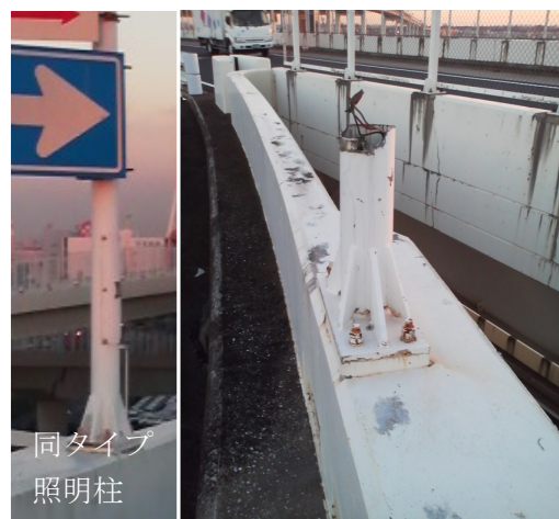
(b) 点検用開口部の破断による落下 (高架橋, 設置後 21 年経過)
