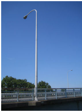
(a) 橋梁部に設置
