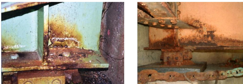
写真-解 1.1 桁端部の部分的な腐食事例
