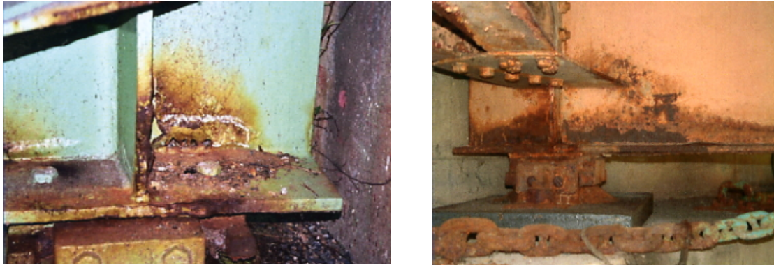
図-1.1 桁端における腐食事例 1.1)
