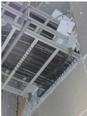
写真 7.4-1 防火区画貫通部の損傷 7-8)
