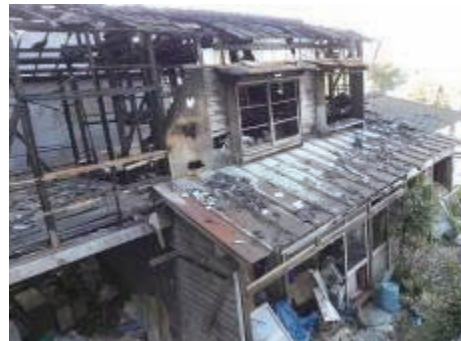
写真 7.2-8 出火した住宅
