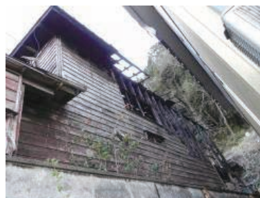
写真 7.2-10 出火した住宅
