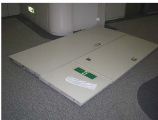
写真 7.4-2 枠から外れた防火戸 7-8)
