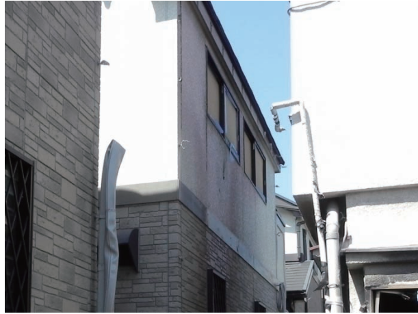
写真 7. 2-24 火元建物の南側の類焼した 2 棟 (奥：2 階ガラス破損（ベニヤ板で補修）、左手前：雨樋の溶融)
