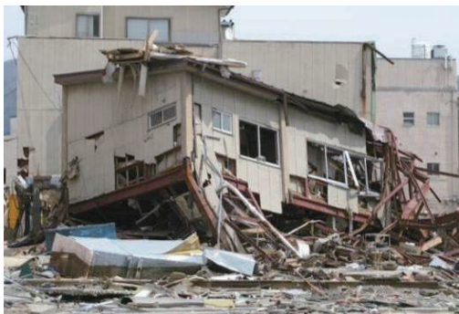
写真 6. 3. 1-7 2階建てS造の1階の崩壊
