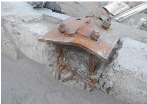
写真 6.3.1-1 柱脚部の破断
