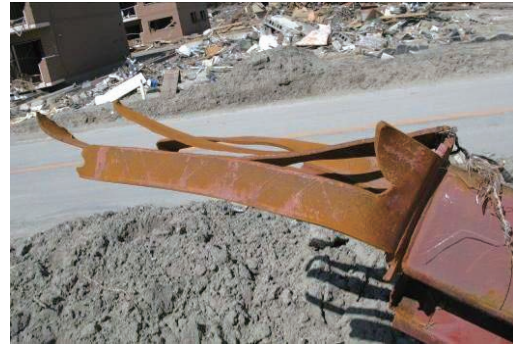
写真 6.3.1-4 引き裂かれた梁フランジ
