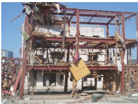
写真 6. 3. 1-9 傾斜した重層建築物
