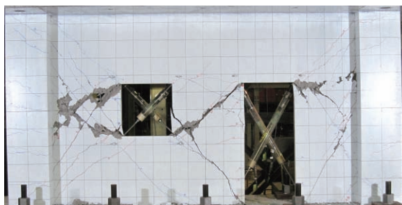
(c) 1/200rad. 加力終了時（最大ひび割れ幅 →ピーク時：12.0mm、除荷時：11.0mm）
