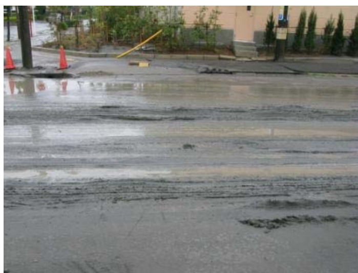
写真-8.1 千葉県浦安市全面液状化の状況
