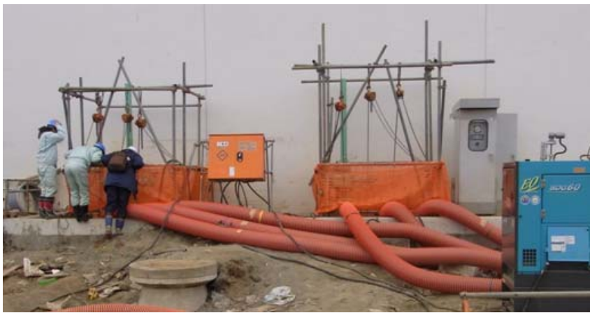
写真-8.7 流入渠からの仮設ポンプによる汚水くみ上げ（宮城県石巻東部浄化センター）
