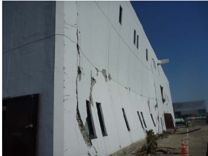
写真-8.4 津波の衝撃で破壊したポンプ棟（仙台市南蒲生浄化センター）
