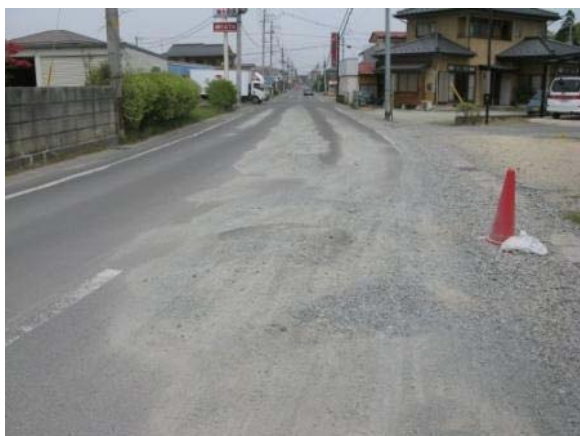
(a) 道路陥没跡
