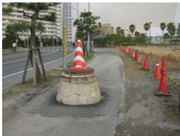
(b) マンホールの浮上
