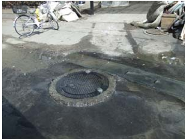
写真-8.6 マンホールからの溢水の状況（宮城県七ヶ浜町内）（資料：国土交通省） ※処理場への導水対策により現地調査時点では溢水は解消していた
