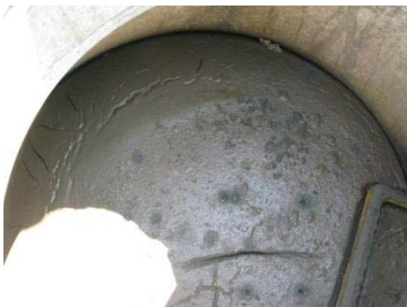
(a) マンホールの閉塞
