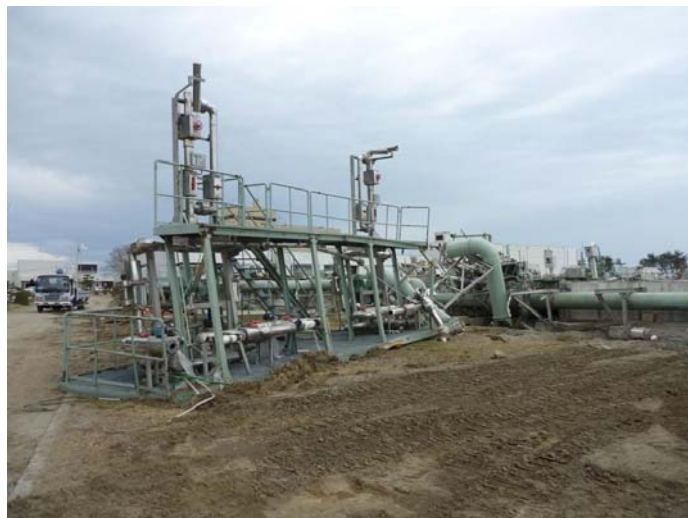
写真-8.5 津波により被災した機械設備（宮城県仙塩流域下水道仙塩浄化センター）
