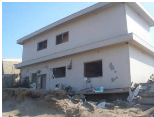
写真2 北側地盤の洗掘
