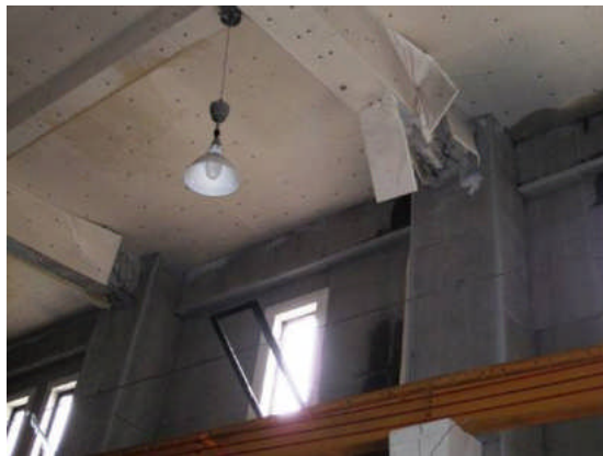
写真 2 3 階梁下端筋の降伏
