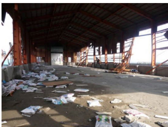
写真3 胴縁の損傷 (倉庫2)
