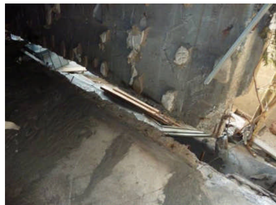
写真 4 主筋が破断した壁脚部
