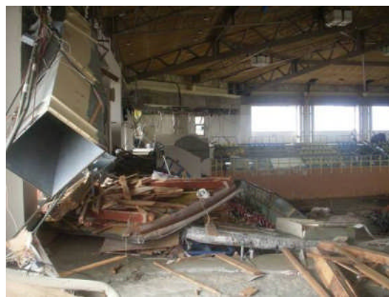
写真 3 体育館内部の状況
