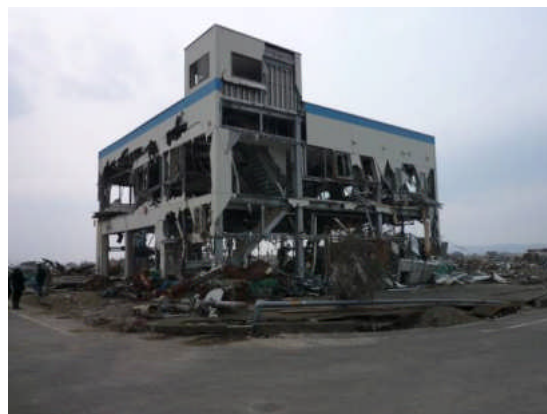
写真 2 外装材の被害
