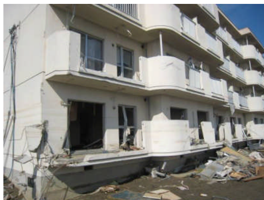
写真3 窓ガラスの破損
