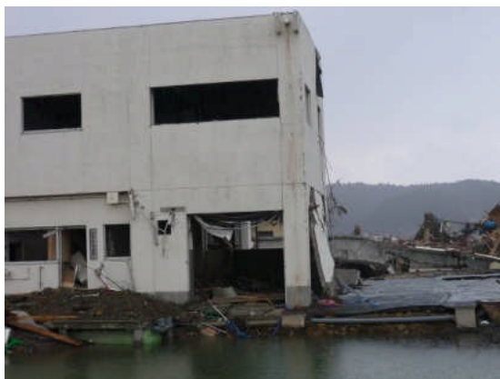
写真3 外壁の面外方向の変形
