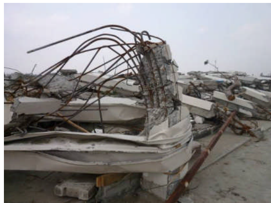
写真 2 倒壊した RC 造柱
