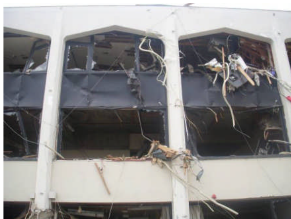
写真 2 開口部と内装材の損壊
