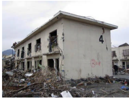
写真2 残存した住棟
