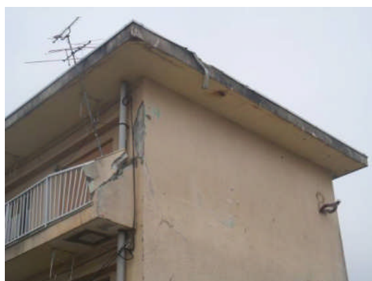
写真3 パラペットの破損
