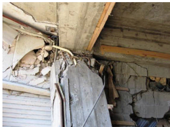
写真4 損傷した RC 柱頭
