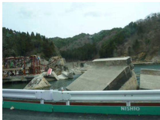
写真4 近傍で決壊した堤防
