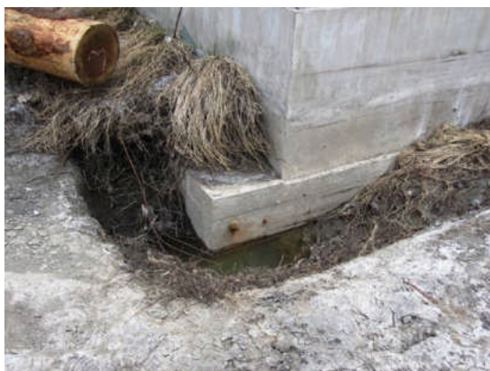
写真3 洗掘した基礎
