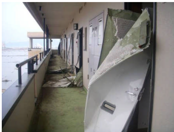
写真4 3階外廊下の被害状況
