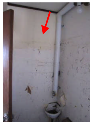
写真2 2 階手洗いの浸水痕
