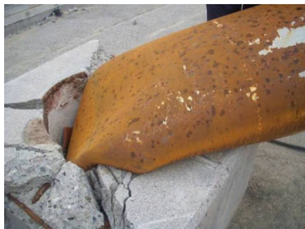
写真2 柱脚部のコンクリートの状況
