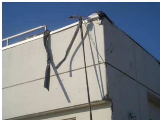
写真2 2階手摺の破損
