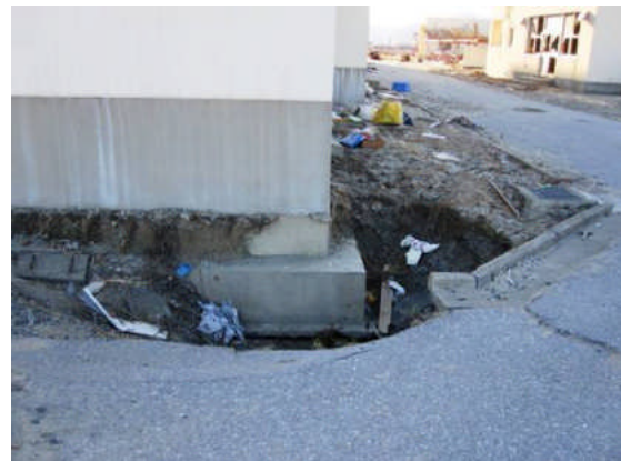
写真4 洗掘した杭基礎(2)
