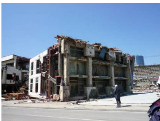
写真1 転倒建物全景
