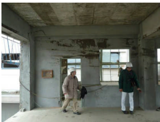
写真3 建物1階の浸水痕
