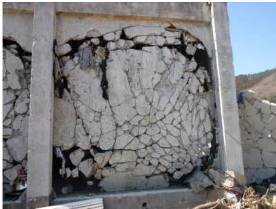
写真 3 RC 造壁の面外破壊
