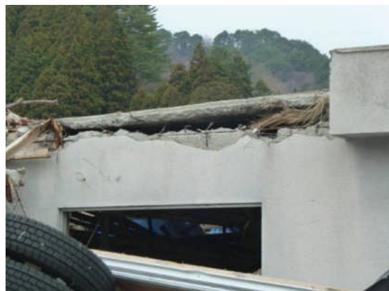
写真2 損傷した屋根部分
