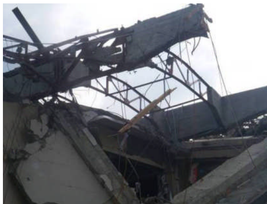
写真 6 屋根の倒壊状況
