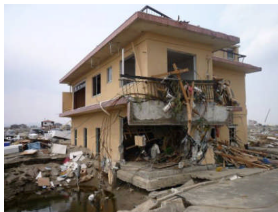
写真 2 1 階妻壁の被害
