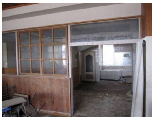
写真 2 室内の浸水痕
