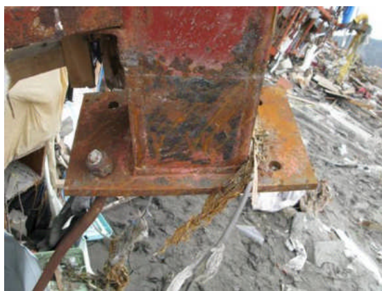
写真4 柱脚ベースプレート
