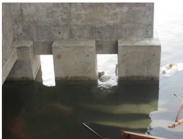
写真3 基礎周辺の洗掘の状況
