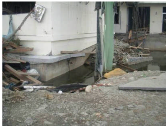
写真7 地盤の洗掘（妻面基礎部分）
