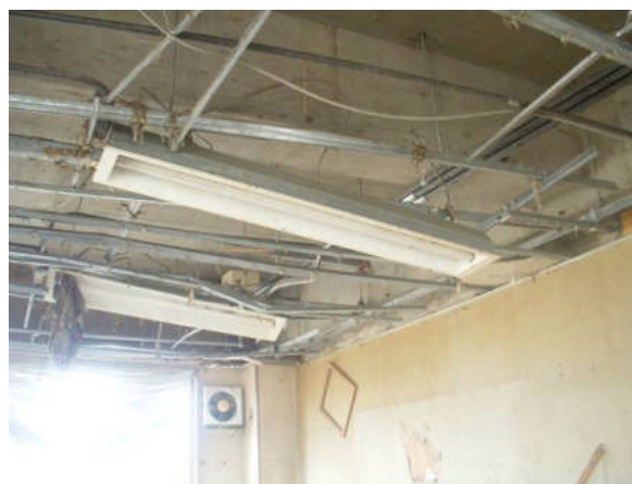
写真 3 1 階天井仕上げ材の被害状況
