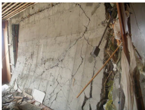
写真2 間仕切り壁の破壊
