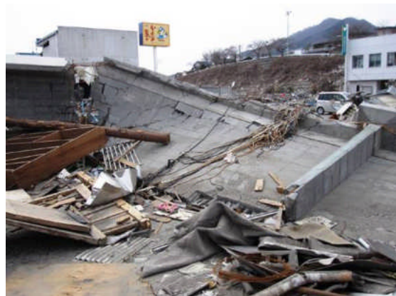
写真2 転倒したコンクリートブロック壁(1)
