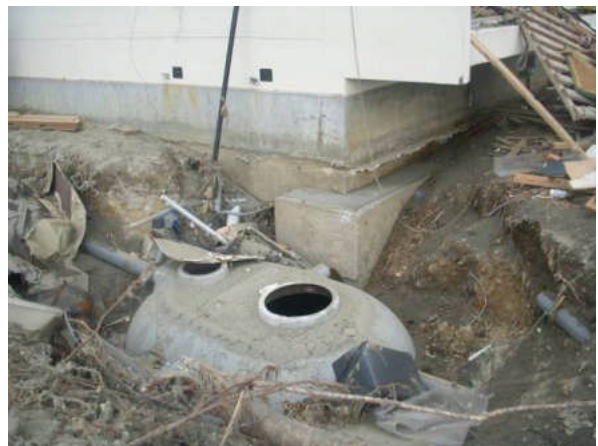
写真4 地盤の洗掘状況
