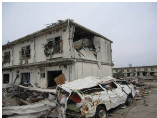
写真2 2階妻壁の損傷
