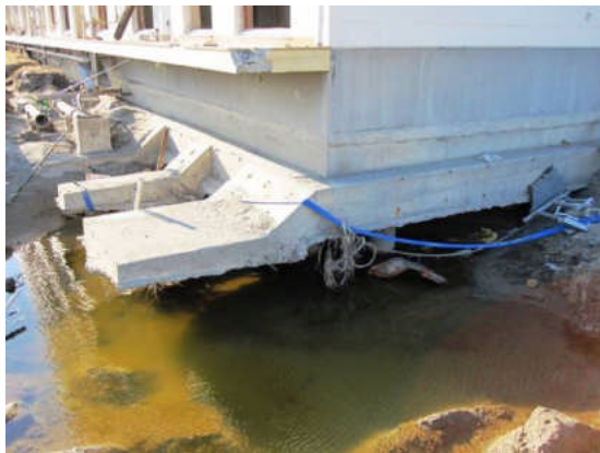
写真3 洗掘した杭基礎(1)
