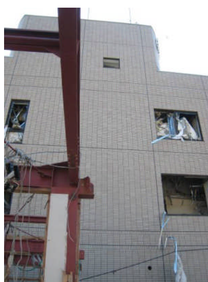
写真 4 ペントハウス天井に痕跡
