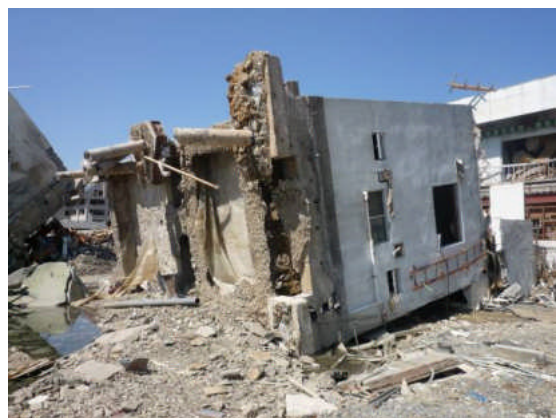
写真2 建物底面 (杭の破損)
