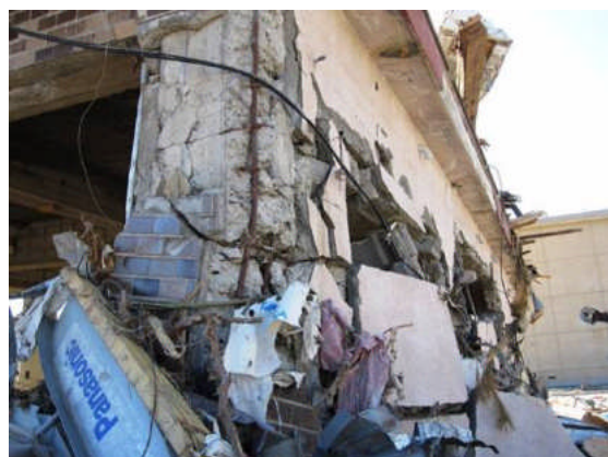
写真4 損傷したコンクリートブロック壁
