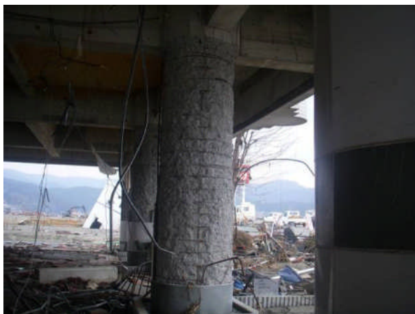
写真3 1階エントランスの被害状況
