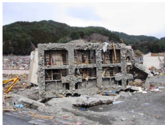
写真3 転倒した基礎断面
