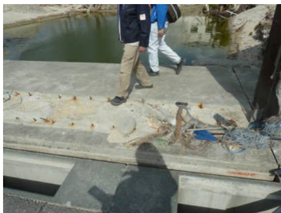
写真2 破断した壁筋
