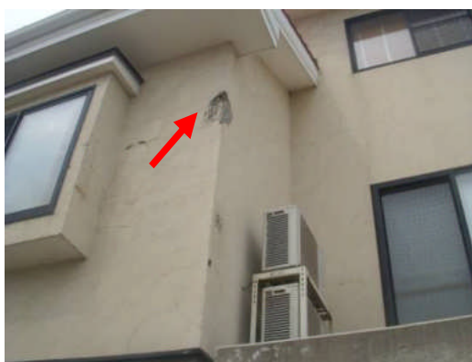
写真4 2階外壁の衝突痕
