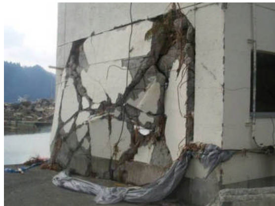
写真4 外壁の破壊状況
