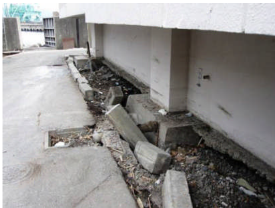
写真 3 洗掘された基礎
