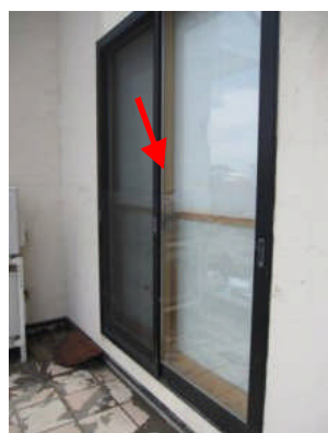
写真3 2階窓ガラス の浸水痕
