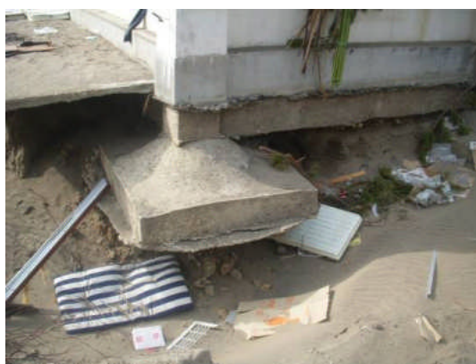
写真3 周辺地盤の洗掘
