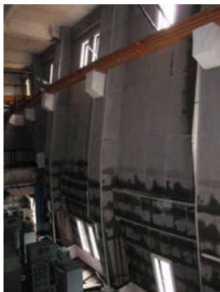
写真 3 耐力壁の面外変形
