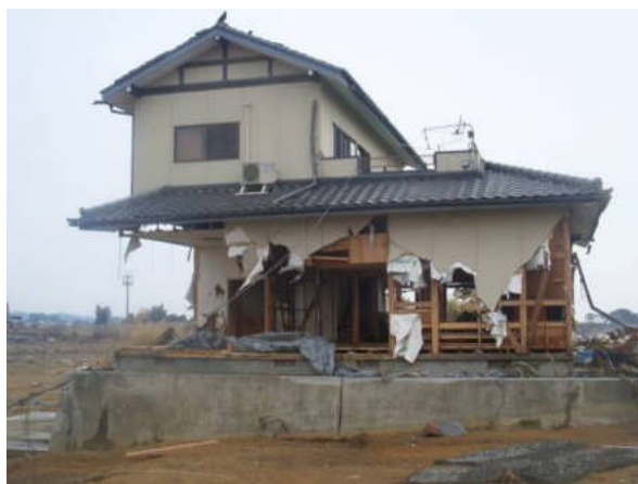
写真1 原位置に残存した住宅
