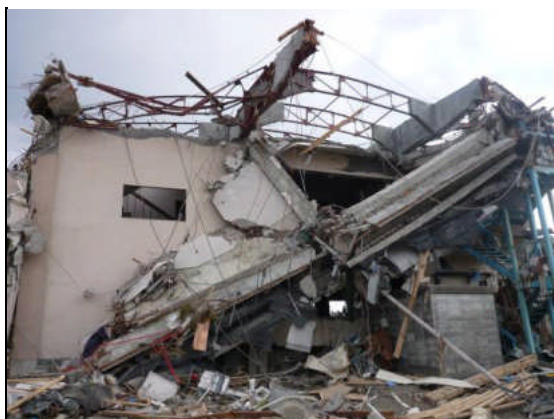
写真 5 ホール側の被害状況
