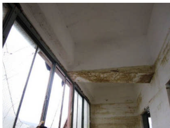
写真4 建物1階の浸水痕
