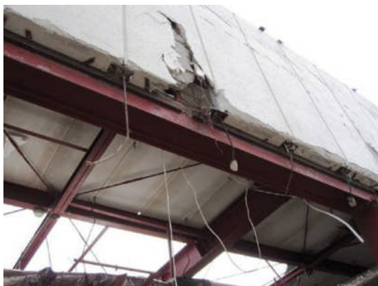
写真 3 損傷した ALC パネル
