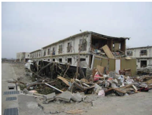
写真1 建物東端1戸分の崩壊
