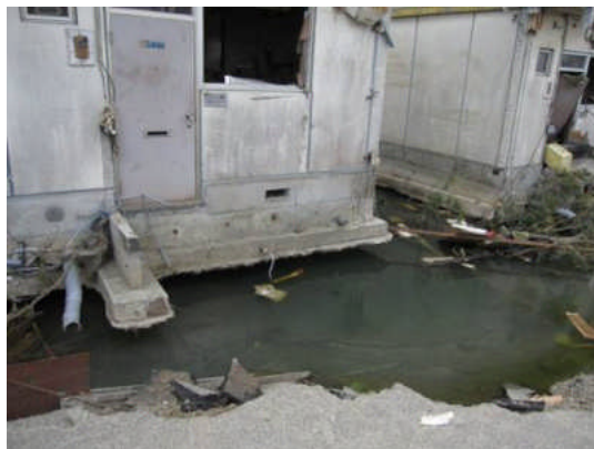
写真3 周辺地盤の洗掘
