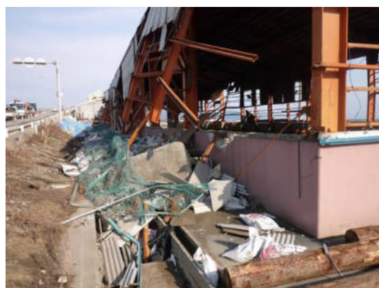
写真4 損傷状況 (倉庫2、道路側)
