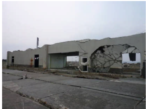
写真2 RC造建物の被害
