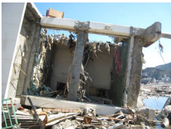
写真3 建物正面 (有開口外壁の破壊)
