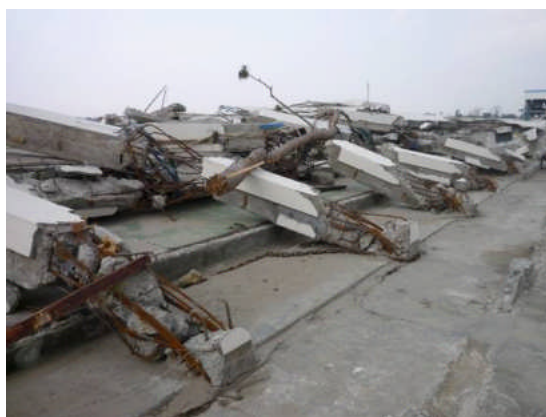
写真 3 柱が同じ方向に倒壊
