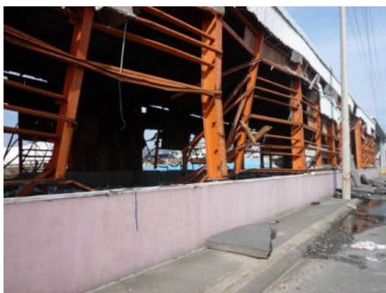
写真 5 柱の変形（倉庫 2）
