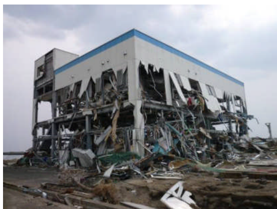
写真 3 2 階天井より下の外装材が流失
