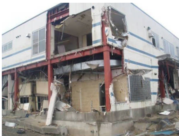
写真3 ALC パネルの脱落
