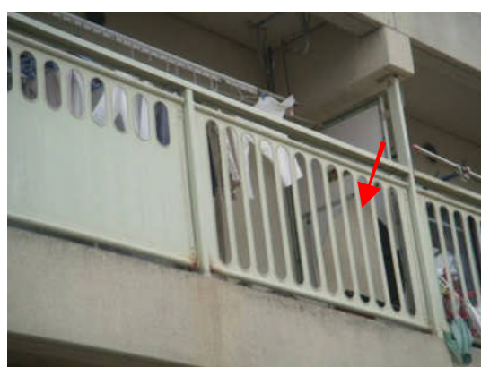
写真2 住戸間の仕切りの破損状況 (2階)
