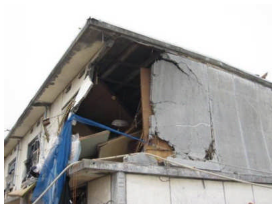
写真2 漂流物の衝突による2階部分の損傷
