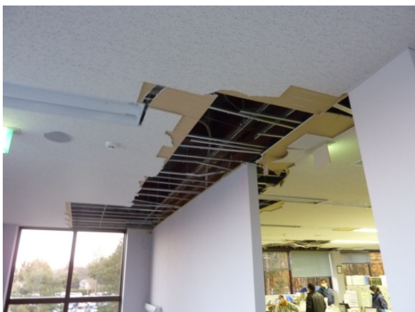
写真 5. 6-36 間仕切り上部での天井の被害
