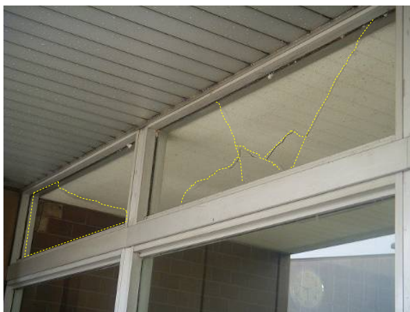
写真 5. 6-22 建物入口のガラスの被害
