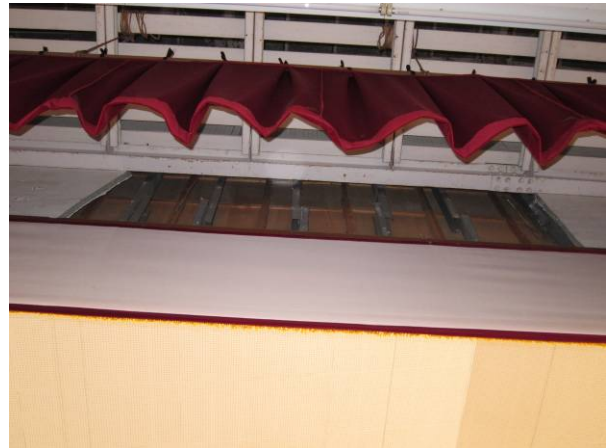
写真 5.6-51 舞台上部の内壁の脱落被害
