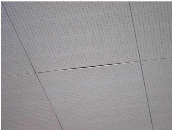
写真 5. 6-46 天井板のとめつけ箇所での浮き
