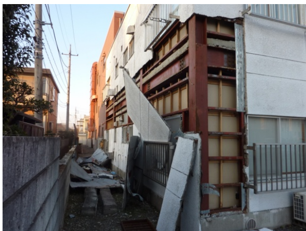
写真 5. 6-28 ラスモルタル外壁の脱落被害
