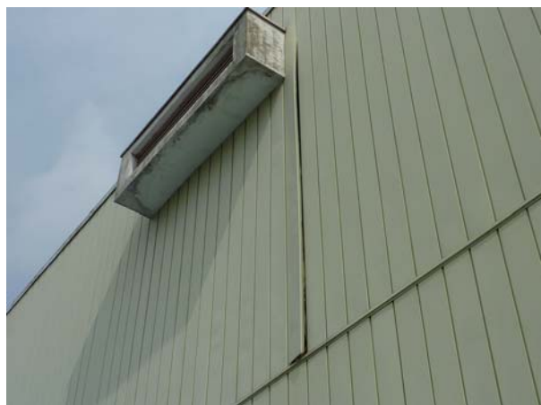
写真 5. 6-64 外壁の金属サイディングの外れ
