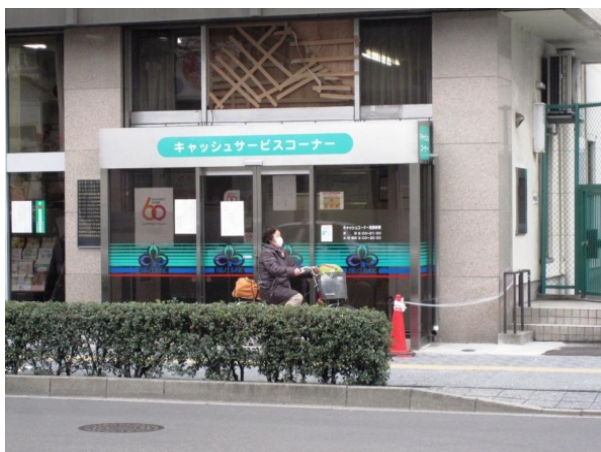
写真 5. 6-10 建物の低層部のガラスの破損
