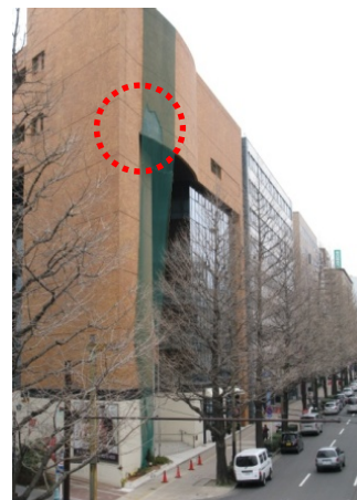
写真 5.6-2 外壁タイルの脱落被害
