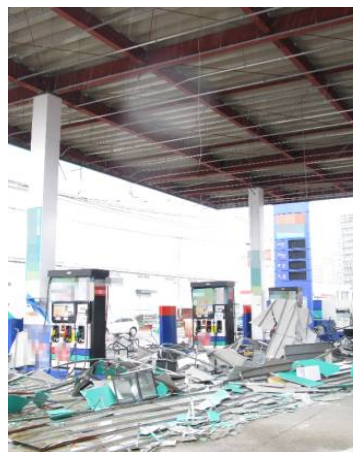
写真 5. 6-13 ガソリンスタンドの天井の被害
