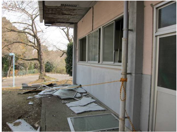
写真 5.6-49 ラスモルタルによる軒天井の被害
