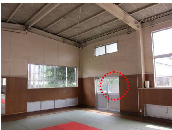
写真 5.6-57 両開きドアのガラスの被害
