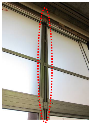
写真 5. 6-60 窓サッシの方立カバーの脱落
