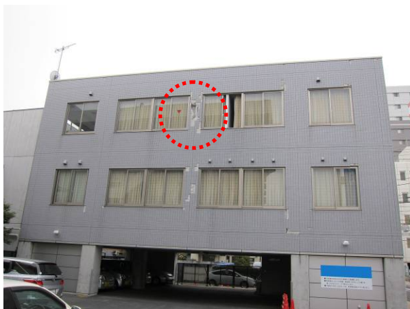
写真 5. 6-30 ALC パネル外壁の被害
