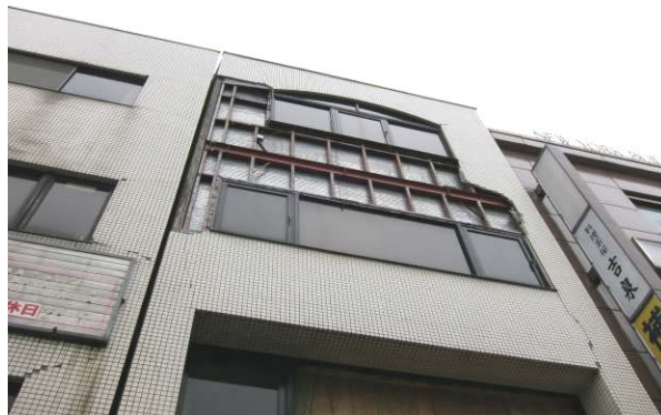
写真 5. 6-29 ラスモルタル外壁の脱落被害
