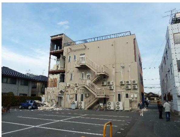
写真 5. 6-18 ALC パネル外壁の脱落被害
