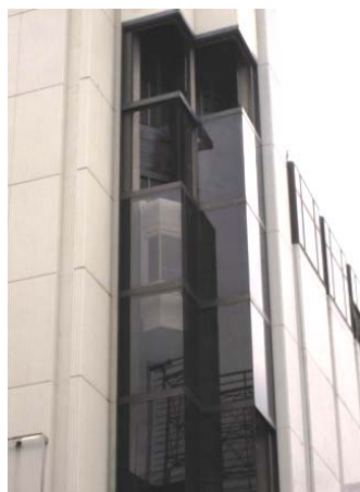
写真 5. 6-11 エレベーター周りのガラス被害
