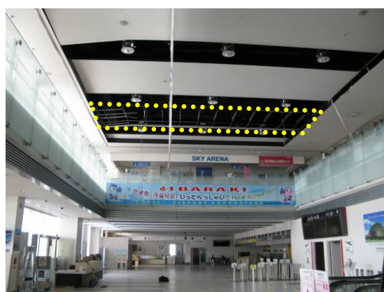
写真 5.6-66 出発ロビー（黄点線が脱落箇所）
