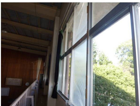
写真 5.6-55 はめ殺し窓のガラスの被害
