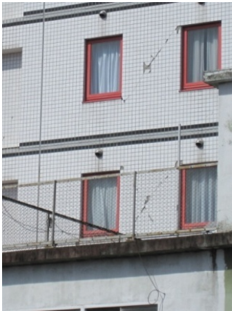
写真 5. 6-14 外壁タイルの脱落被害
