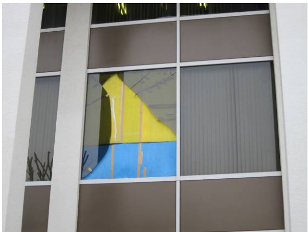
写真 5. 6-34 窓ガラスの被害
