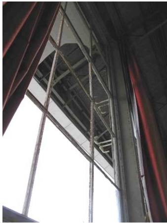
写真 5.6-48 在来工法による軒天井の被害
