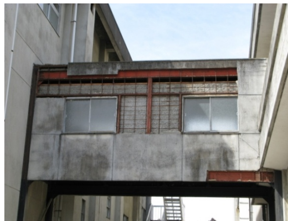
写真 5. 6-17 ラスモルタル外壁の脱落被害
