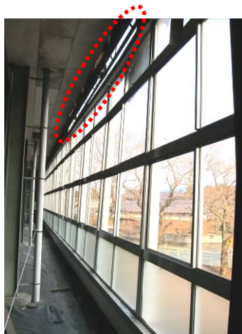
写真 5. 6-59 窓サッシの外側への倒れ
