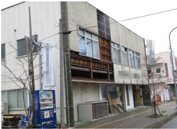
写真 5. 6-3 ラスモルタル外壁の脱落被害
