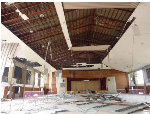
写真 5.6-40 在来工法による天井等の脱落被害
