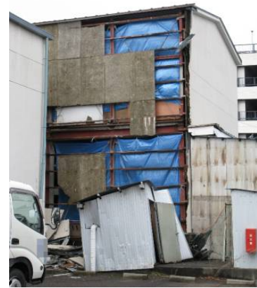
写真 5. 6-4 ラスモルタル外壁の脱落被害
