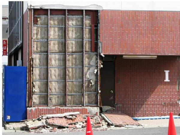
写真 5. 6-15 ラスモルタル外壁の脱落被害
