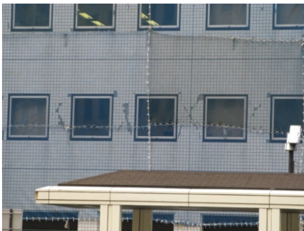
写真 5.6-1 外壁タイルの脱落被害
