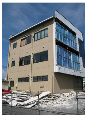
写真 5. 6-19 ALC パネル外壁の脱落被害
