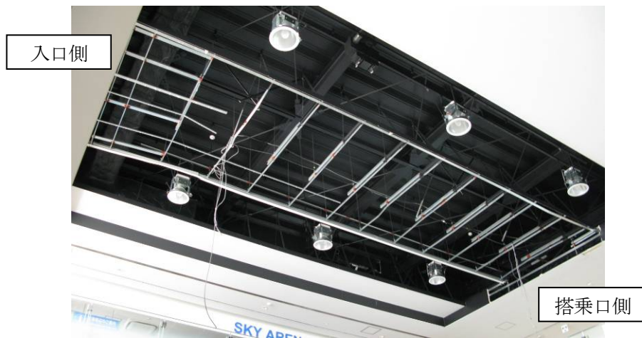
写真 5. 6-67 天井 B の残った下地の様子（出発ロビーからの見上げ）
