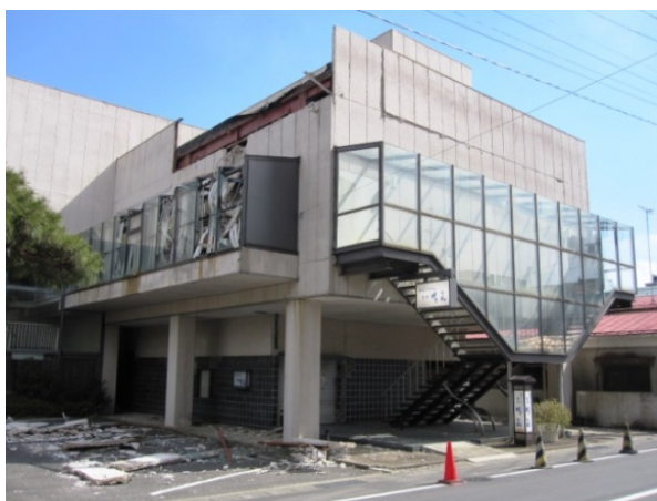
写真 5. 6-20 ALC パネル外壁の脱落被害
