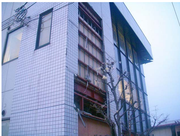
写真 5. 6-16 ラスモルタル外壁の脱落被害
