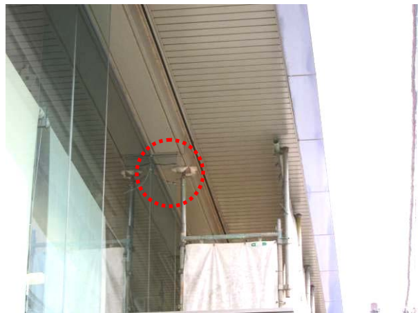
写真 5. 6-35 ガラススクリーンの被害
