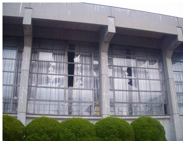
写真 5. 6-23 体育館の窓ガラスの被害
