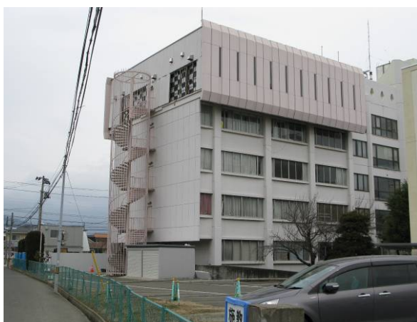
写真 5. 6-21 ALC パネル外壁の脱落被害
