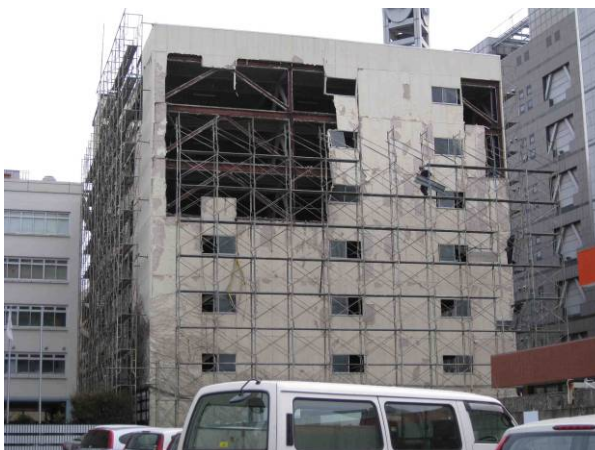
写真 5. 6-31 ALC パネル外壁の被害
