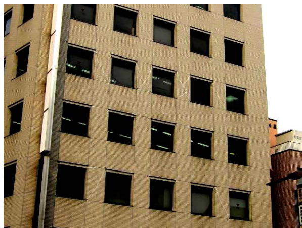
写真 5.6-27 外壁タイルの被害
