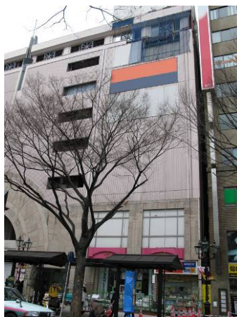
写真 5. 6-8 ALC パネルの脱落被害
