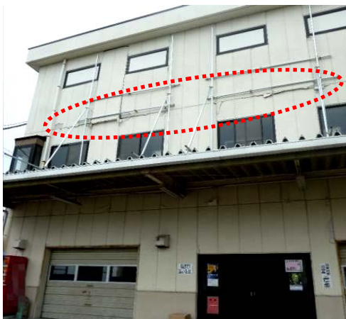
写真 5. 6-5 ALC パネルの損傷被害
