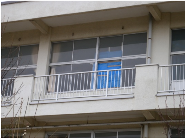
写真 5. 6-32 窓ガラスの被害
