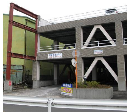
写真 5. 6-9 ALC パネルの脱落被害
