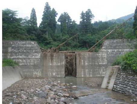
小矢部川水系打尾川(南砺市 大鋸屋地内) コンクリート製透過型堰堤が流木を捕捉
