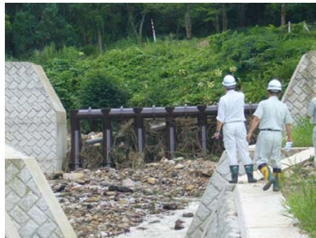
小矢部川水系セド谷(南砺市 オ川七地内) 鋼製透過型堰堤が流木を捕捉
