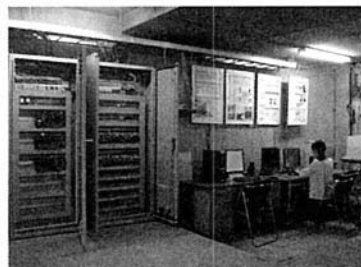
制御室（制御盤、制御用PC）
