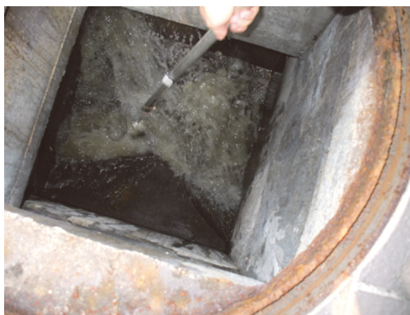
写真－3.2 ポンプ作動時の汚水枳の状況 ※汚水枳内で激しく流下。下水のサンプリングも困難。
