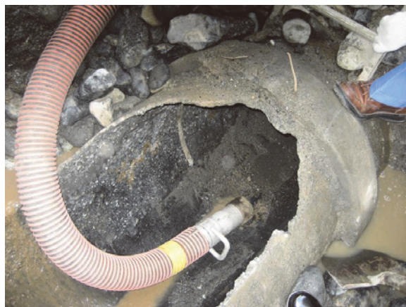
写真－1.1 硫化水素が原因の下水管破損事例
