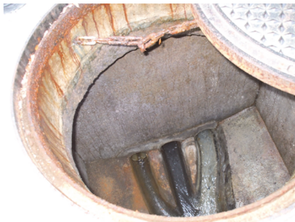
写真－3.1 汚水枳の状況 ※複数の別系統管が複数流入
