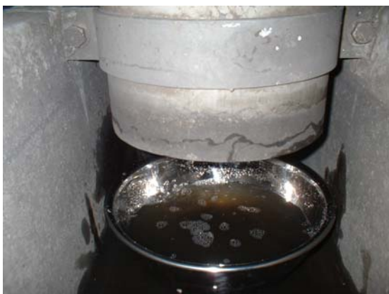
写真 3.1 雨水管の流出状況 (1 回目調査)
