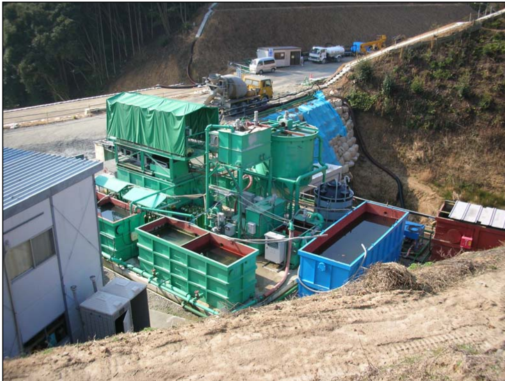
1) トンネル坑口付近に設置した濁水処理プラントの例
