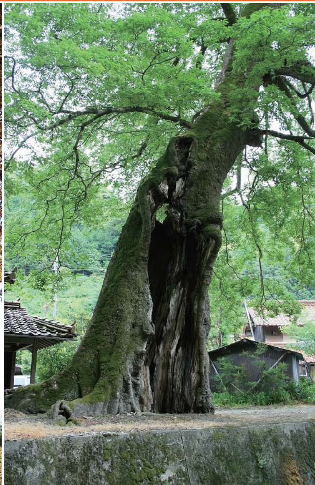
殺菌剤塗布のみの処置（ムクノキ）
