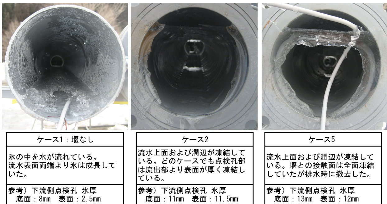
写真-3 24 日 9 時の管内の凍結状況
