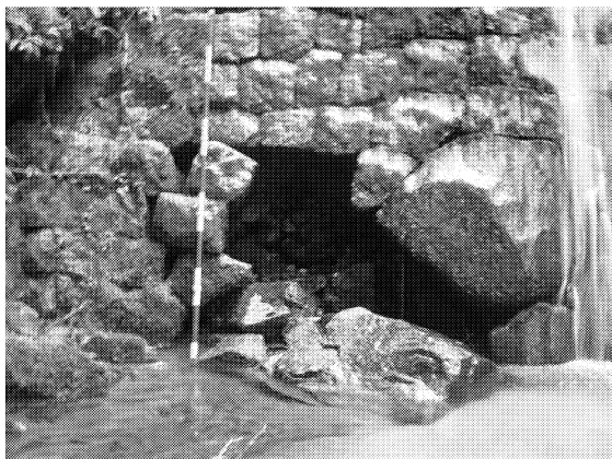
基礎の洗掘により最下部の積み石が欠落した事例
