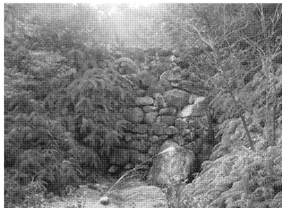
植生により施設の変状確認が困難な事例
