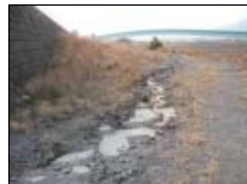
雨水による基盤侵食
