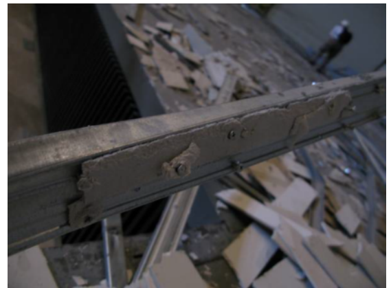
図-4.45 脱落したダブル野縁
