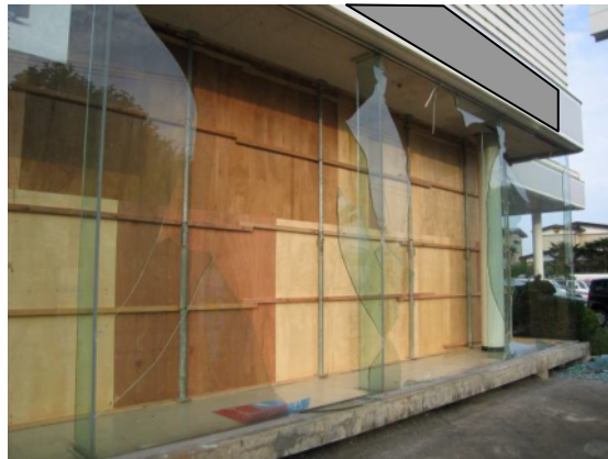
図-4.48 被害のあったガラス箇所
