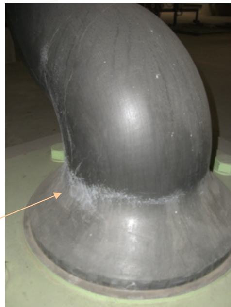
(b) 表面の変状
