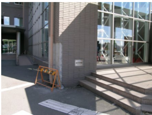
(c) 外装タイルの剥落
