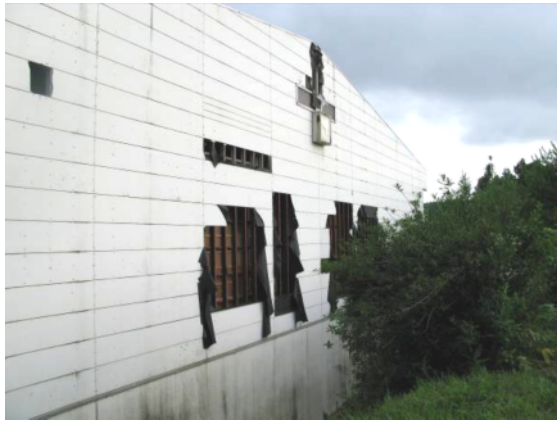
図-4.11 妻面（舞台裏）の外装材の損傷
