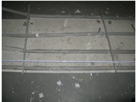
図-4.43 脱落した天井板とダブル野縁
