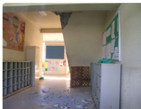
(d) 1階階段上部の損傷
