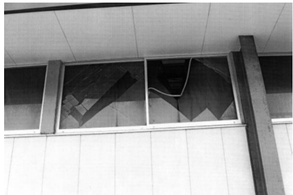
図-4.3 破損した窓ガラス（学校提供）
