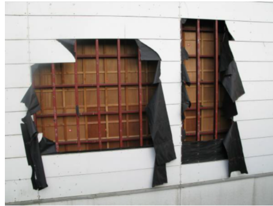
図-4.12 外装材損傷箇所
