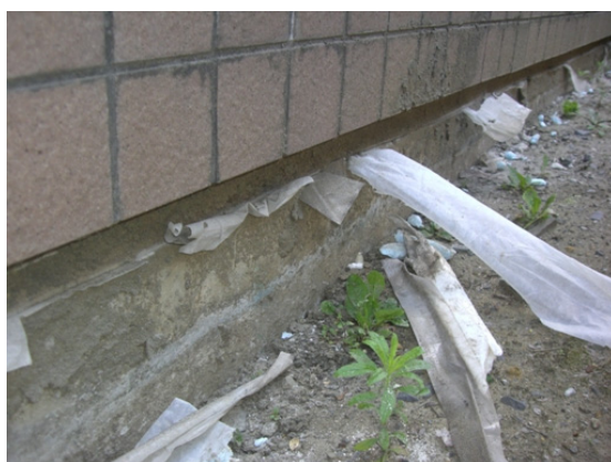
図-5.4.7 フィルム状シートのはみ出し（東側外周部）
