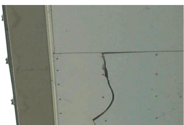
図-4.21 軒天の破損状況ととめ付け状況
