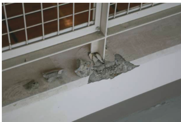
図-4.18 ギャラリー手すりの脚部の損傷
