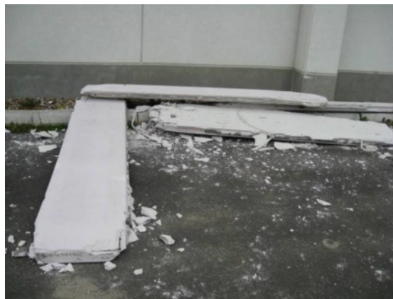
図-4.11 脱落したALCパネル
