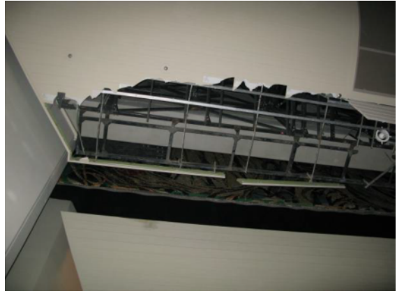
図-4.39 同部の舞台左側の損傷箇所
