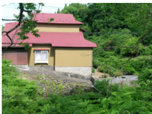
(a) 擁壁の亀裂があった住宅
