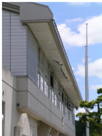
(a) 南側被害状況
