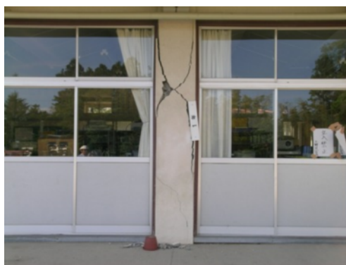
(b) 1階柱のせん断破壊
