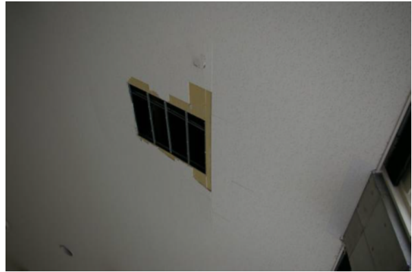
図-4.29 天井板脱落箇所
