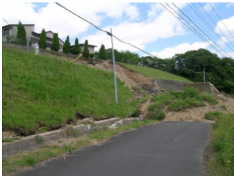
(a) 南側斜面擁壁の崩壊
