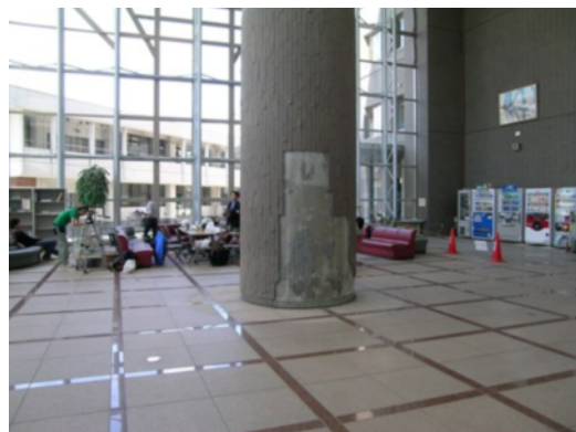
(d) 内部柱の仕上げタイル剥落
