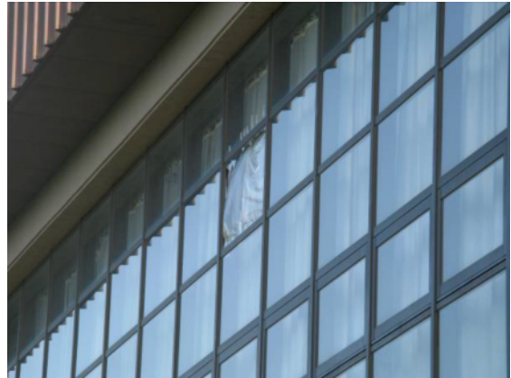
図-4.24 ガラスの破損
