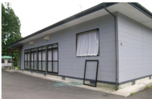
(a) 建築物F（窓サッシ脱落）
