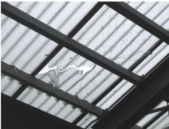
図-4.28 破損したガラス
