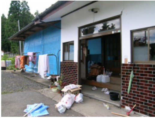
(a) 外壁損傷及びサッシの脱落
