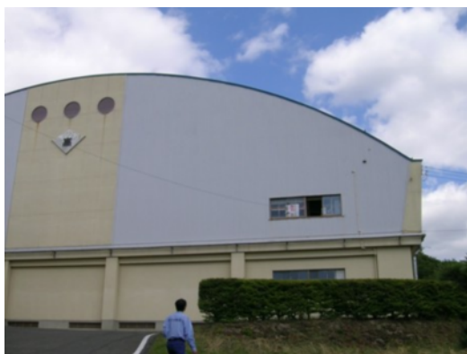
(a) 体育館妻面の窓ガラス破損
