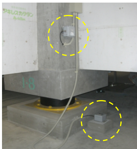
図-5.4.2 免震層内の強震計設置状況
