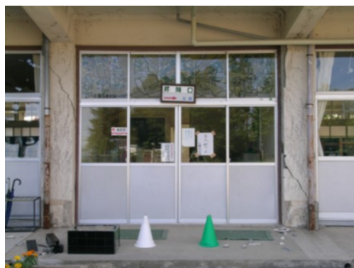
(c) 1階出入口脇の柱の損傷
