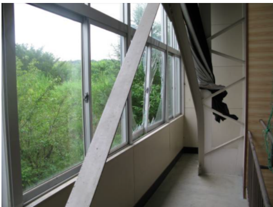
図-4.9 ブレースの座屈とガラスの破損
