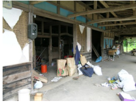
(b) 同住宅牛小屋の土壁剥落
