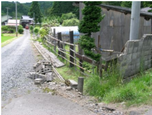
(a) ブロック塀の倒壊
