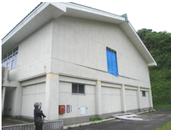
図-4.10 C建築物のALCパネル脱落状況
