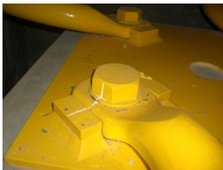
(a) 鋼材ダンパー取り付けボルト部
