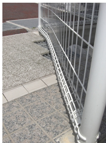
(b) 侵入防止柵のゆがみ
