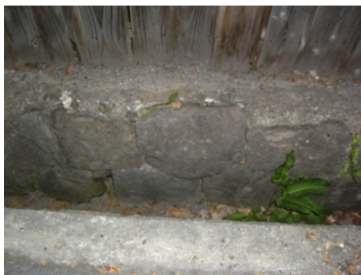
(b) 擁壁モルタルはがれ
