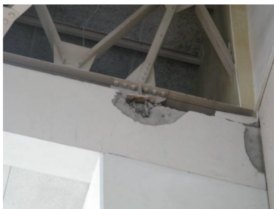
図-4.18 屋根支承部の損傷
