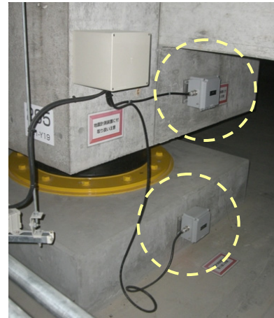
(b) 免震層内
