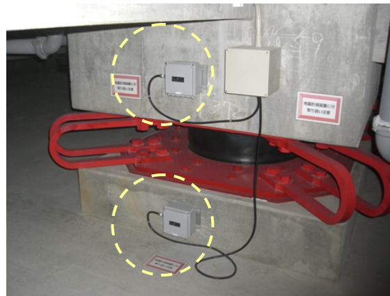
(b) 免震層内
