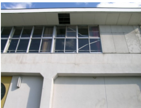
(b) 軒天落下及びブレース座屈
