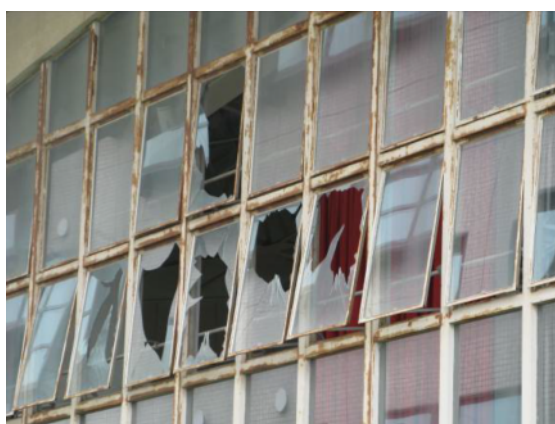
図-4.20 北側妻面の窓ガラスの損傷
