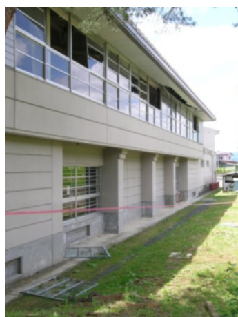
(c) 北側被害状況
