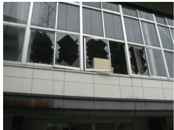
図-4.10 ガラスの破損、障子の脱落（南西側）
