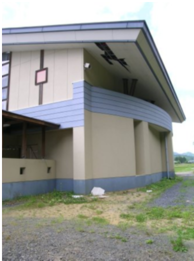
(a) 軒天外装材落下
