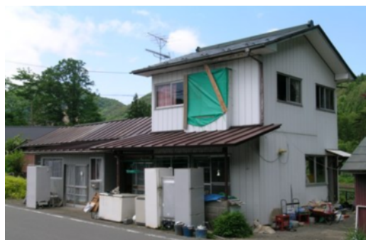
(b) 住宅の窓の損傷
