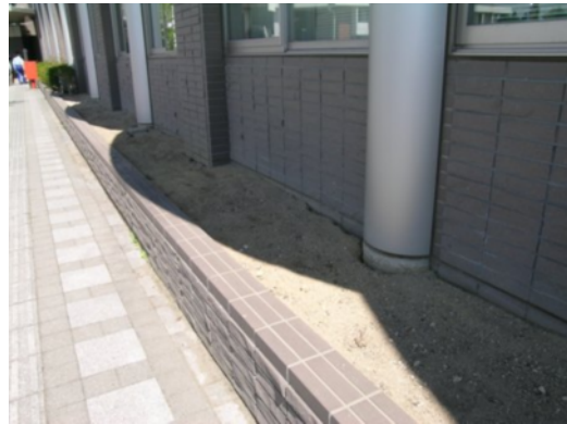
(b) 建築物脚部の地盤との隙間
