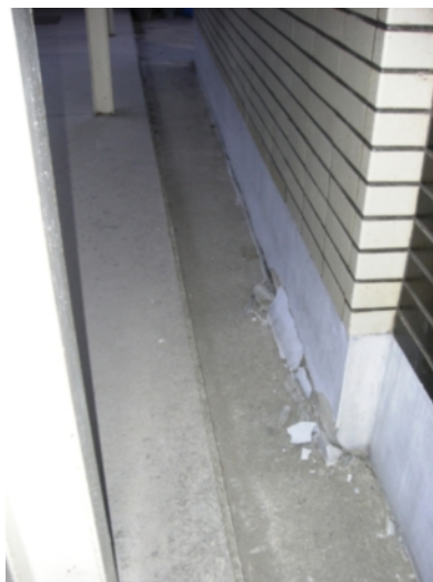
(a) 新校舎東側妻壁脚部の破損
