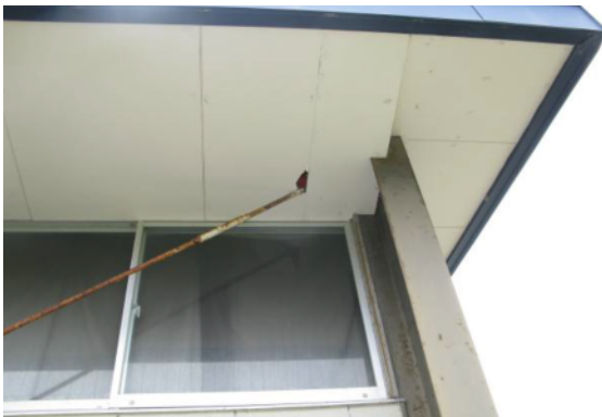
図-4.4 破損した軒天井
