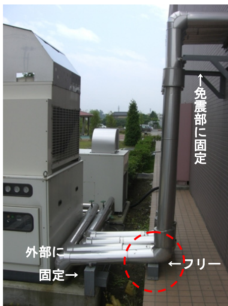
(a) 接続状況
