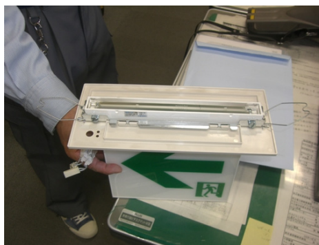
図-5.4.5 落下した誘導灯
