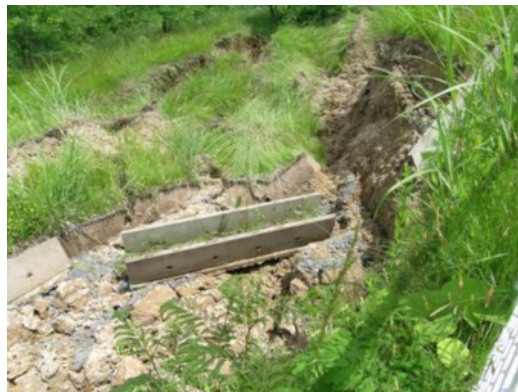
図-2.3.3 B小学校校庭南側の法面崩壊
