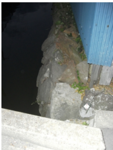
(a) 擁壁はらみ出し
