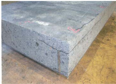
写真 4.6-1 床版断面のひび割れ
