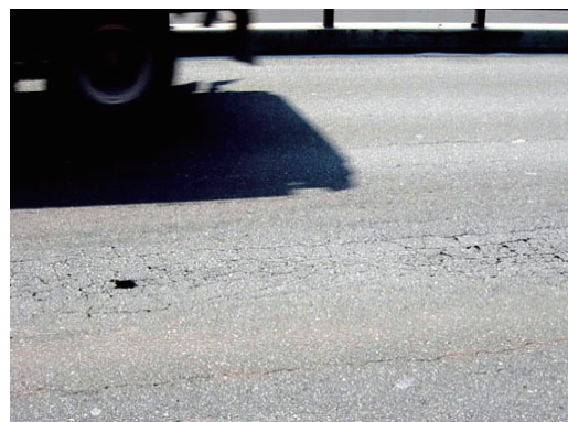
写真 4.3-63 舗装の損傷状況
