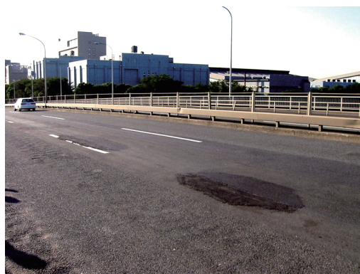
写真 4.3-35 舗装の補修痕
