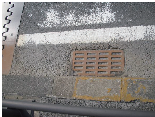
写真 4. 3-105 排水柵の閉塞
