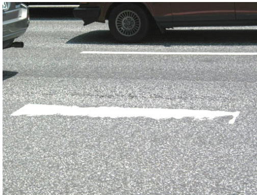
写真 4.3-68 主桁位置の舗装ひび割れ
