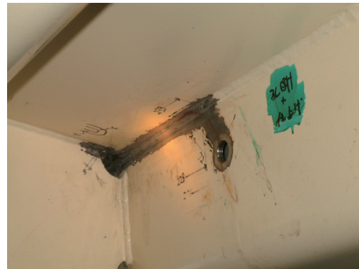
写真 4.3-49 ストップホール
