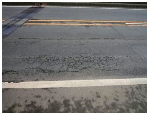
写真 4. 3-53 路面損傷状況
