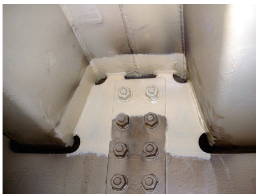
写真 4. 3-119 溶接補修の痕跡
