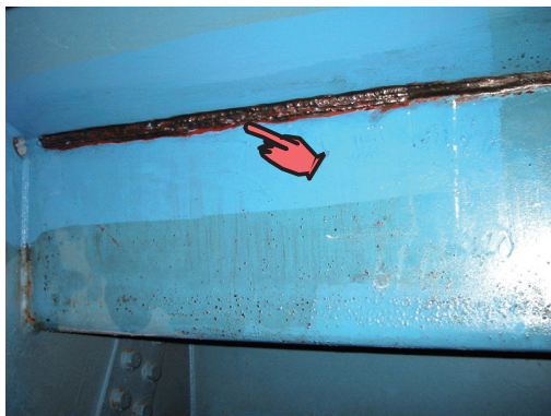
写真 4.3-111 溶接補修の痕跡
