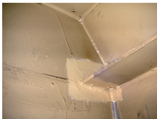
写真 4.3-118 溶接補修の痕跡
