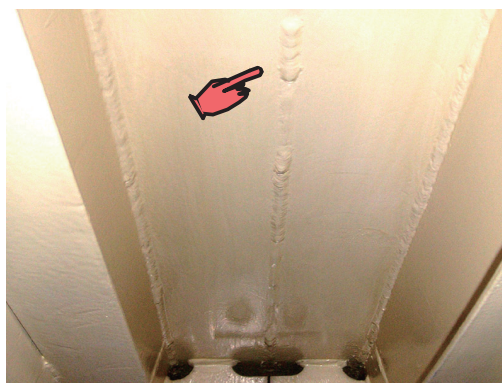
写真 4. 3-120 溶接補修の痕跡
