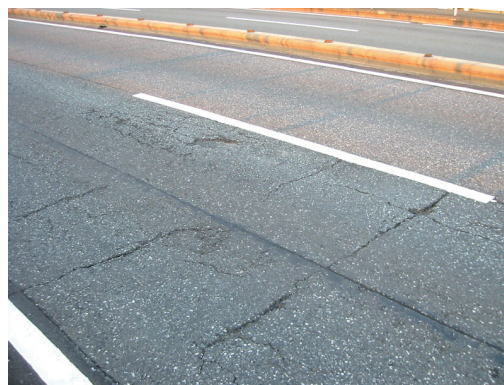
写真 4.3-41 舗装の劣化状況
