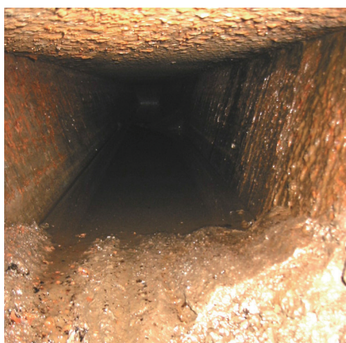
写真 4.2-3 トラフリブ内部に堆積した土砂
