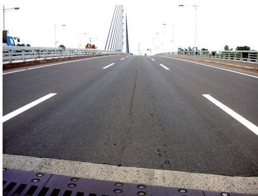
写真 4.3-15 縦方向の舗装ひび割れ
