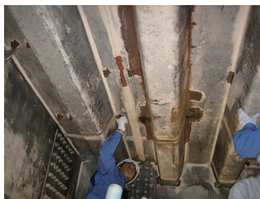
写真 4. 3-57 ビード貫通き裂
