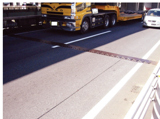
写真 4.3-22 交通実態と路面の状況
