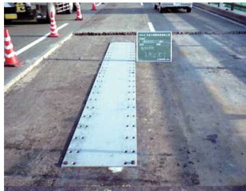
写真 4.3-61 疲労き裂の補強状況 4.6)
