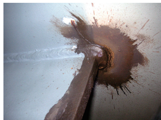
写真 4.3-79 垂直補剛材部の疲労き裂
