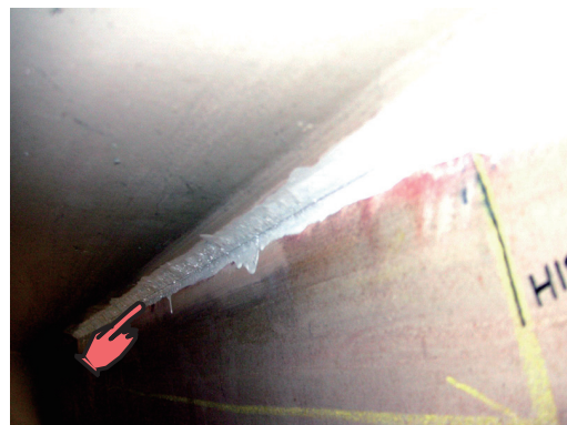
写真 4. 3-136 ビード貫通き裂
