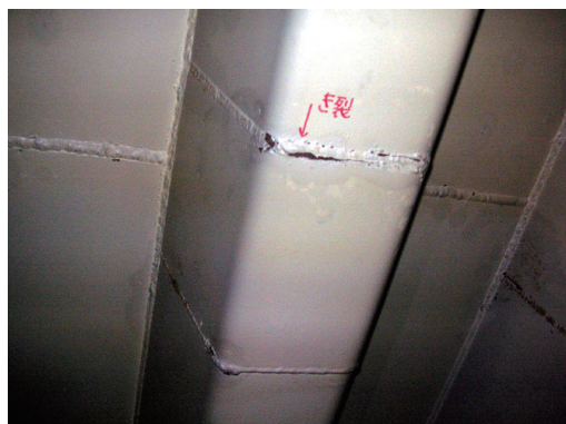
写真 4.3-115 疲労き裂の一例
