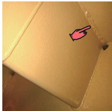
写真 4.3-112 溶接補修の痕跡
