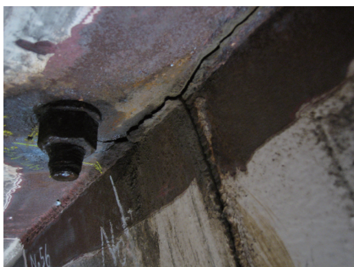
写真 4. 3-54 トラフリブ継手部からのき裂
