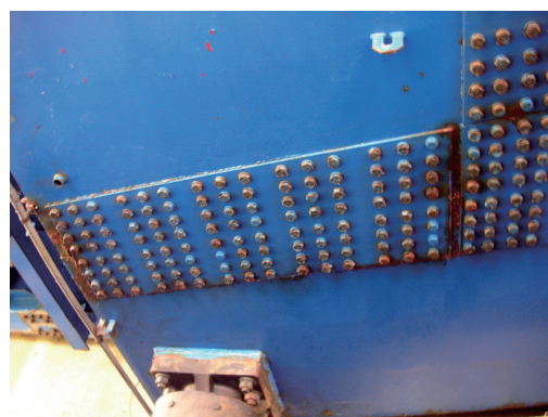
写真 4.3-16 ボルト添接部の腐食
