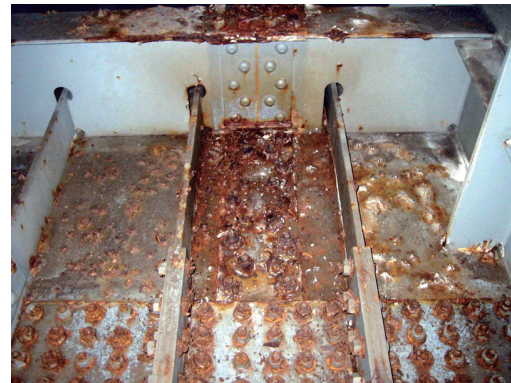
写真 4. 3-132 主桁下フランジの腐食
