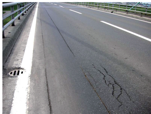
写真 4.3-2 舗装ひび割れ
