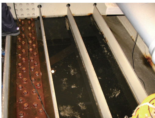
写真 4. 3-139 箱桁内部の滞水状況
