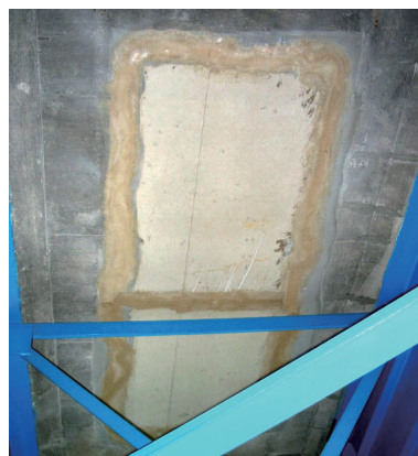
写真 4. 3-106 RC 床版の補修痕
