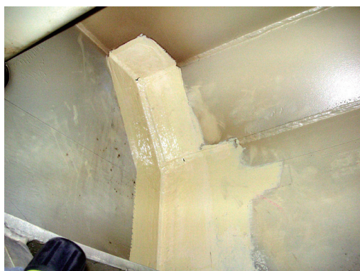
写真 4.3-117 溶接補修の痕跡
