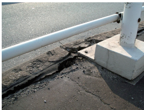
写真 4.3-100 地覆コンクリートの破損
