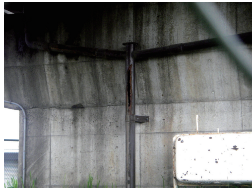
写真 4.3-6 排水管の腐食
