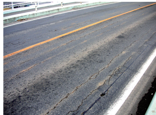
写真 4.3-77 舗装の損傷状況
