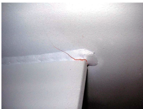
写真 4.3-78 垂直補剛材部の疲労き裂
