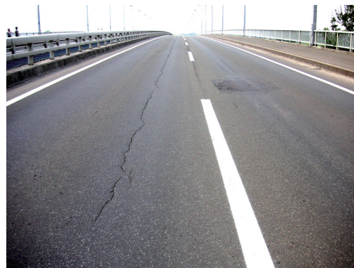
写真 4.3-18 舗装のひび割れと損傷
