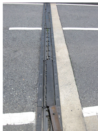
写真 4.3-96 伸縮装置の破損
