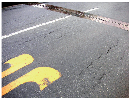
写真 4.3-152 舗装ひび割れの例
