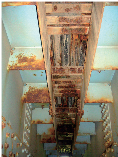
写真 4.3-11 伸縮装置の腐食
