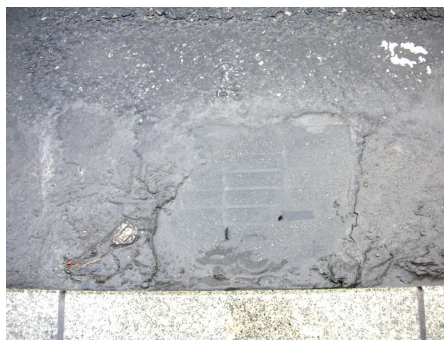
写真 4. 3-160 排水枥の閉塞状況
