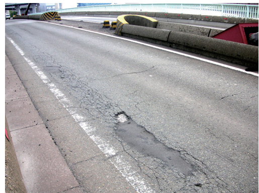
写真 4. 3-89 舗装損傷の一例
