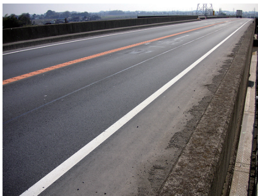
写真 4. 3-52 路面損傷状況
