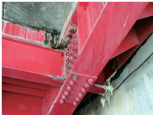
写真 4.3-94 桁端部における漏水と遊離石灰
