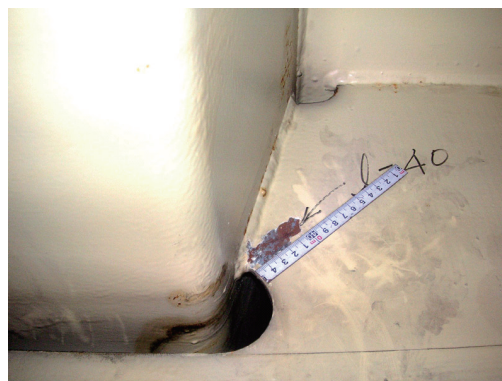
写真 4.3-116 疲労き裂の一例
