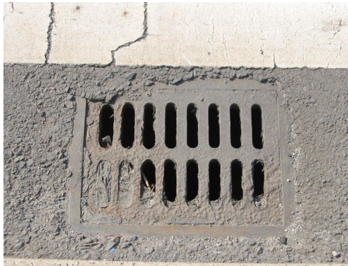
写真 4. 3-131 排水柵の機能低下
