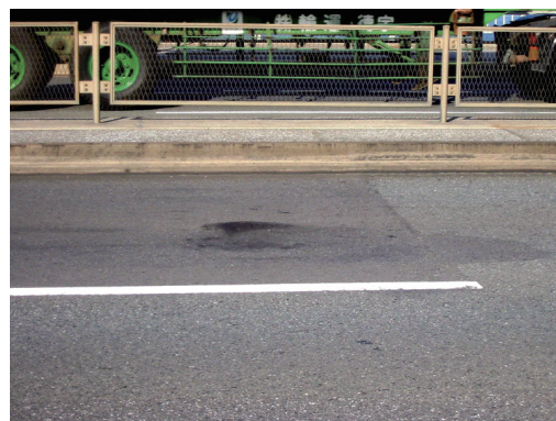
写真 4.3-33 舗装の補修痕と劣化箇所
