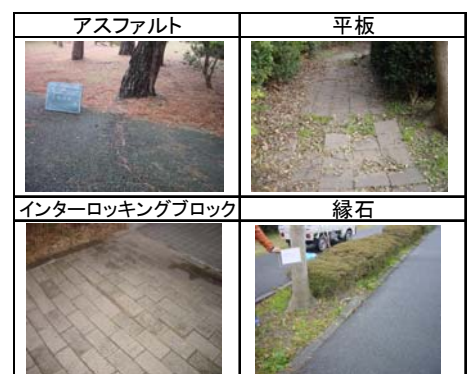
写真1 構造物被害の状況
