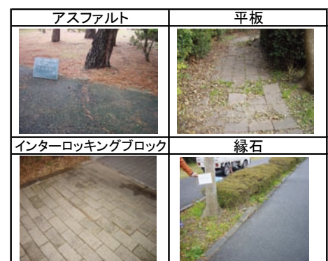
写真1 構造物被害の状況
