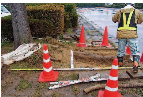
写真5 センダン根系による被害
