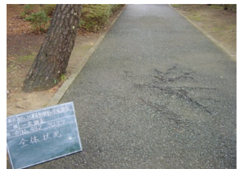
写真2 クロマツによる被害
