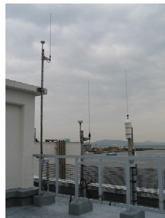
久里浜基地局の受信アンテナ
