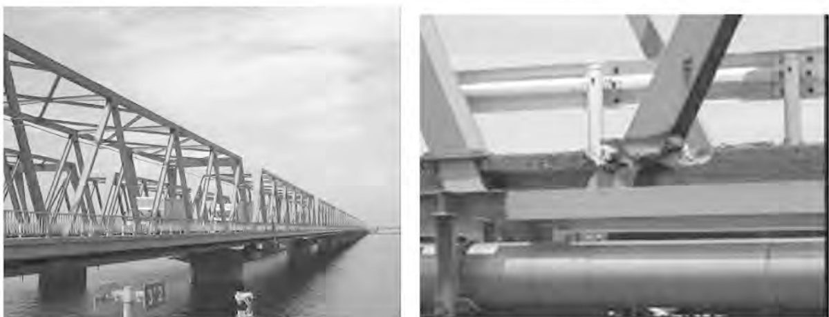
写真－２ 斜材が破断した木曽川大橋
