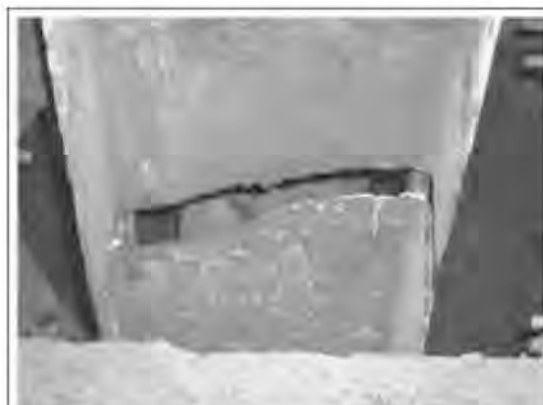
斜材の破断(1箇所)
