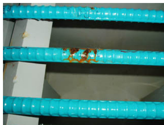
写真 2.3.2 錆汁の流出状況
