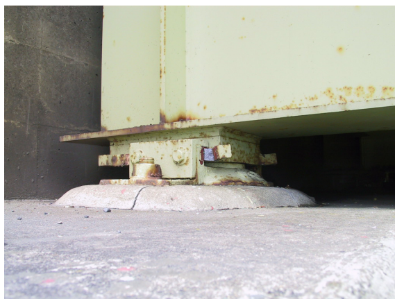
写真 2-5 鳴瀬大橋の支承部の損傷状況
