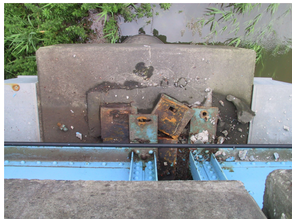
写真 2-2 小野橋の支承の破壊状況
